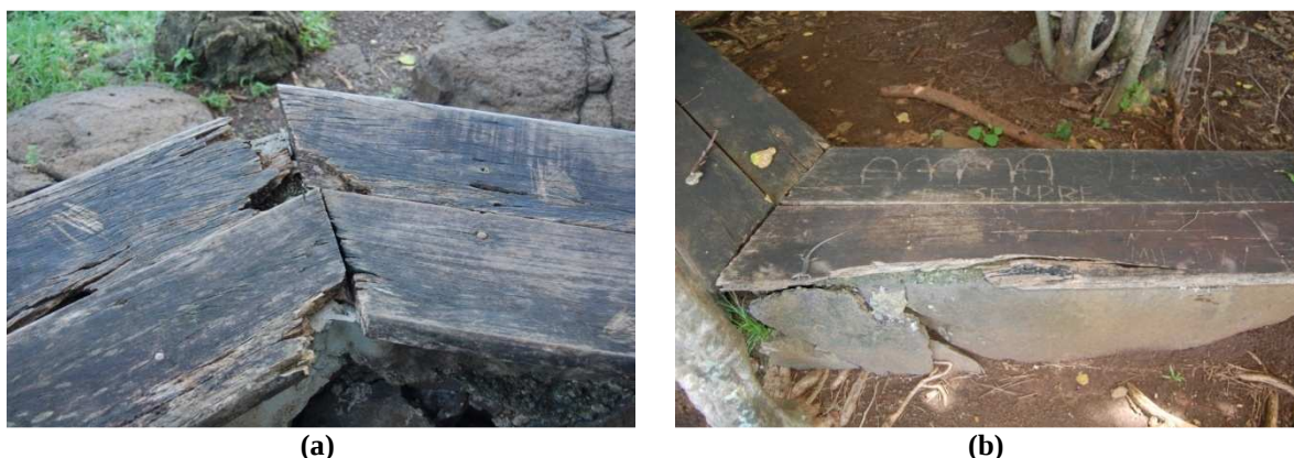
Figura 21: Em (a), peças de madeira do assento de um banco com visíveis avarias; e em (b), madeira parcialmente destruída de um banco, destacando-se as marcas de vandalismo, como a escrita de nomes e datas de visitação.
