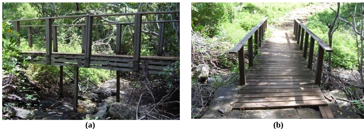
Figura 20: Em (a), estrutura de uma das pontes da Trilha entre Sancho e Mirante dos Golfinhos escorada com estacas de madeira; e em (b), observa-se, leve torção em relação ao seu eixo longitudinal.
