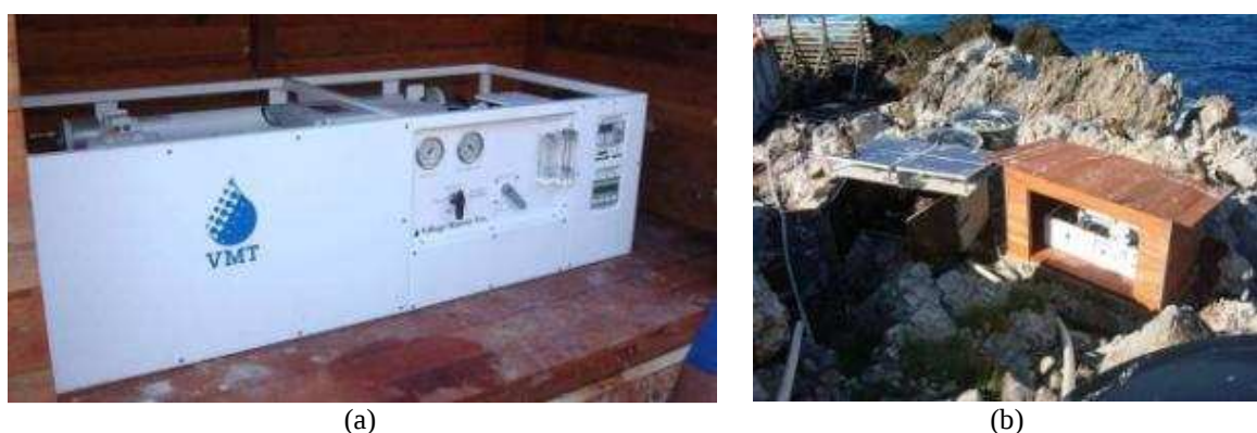
Figura 67: Em (a), dessalinizador da Village Marine Technology (VMT) instalado no ASPSP. Fonte: SECIRM, 2008, apud GUMZ, 2008, p. 142); e em (b), vista das duas edificações anexas construídas para abrigar os dessalinizadores, sendo que a menor, pintada, abrigava o aparelho da primeira Estação. Posteriormente, foi desativada e desmontada e atualmente abriga aparelhagem de telefonia pública. Fonte: Marco Antônio Carvalho de Souza (2008).
