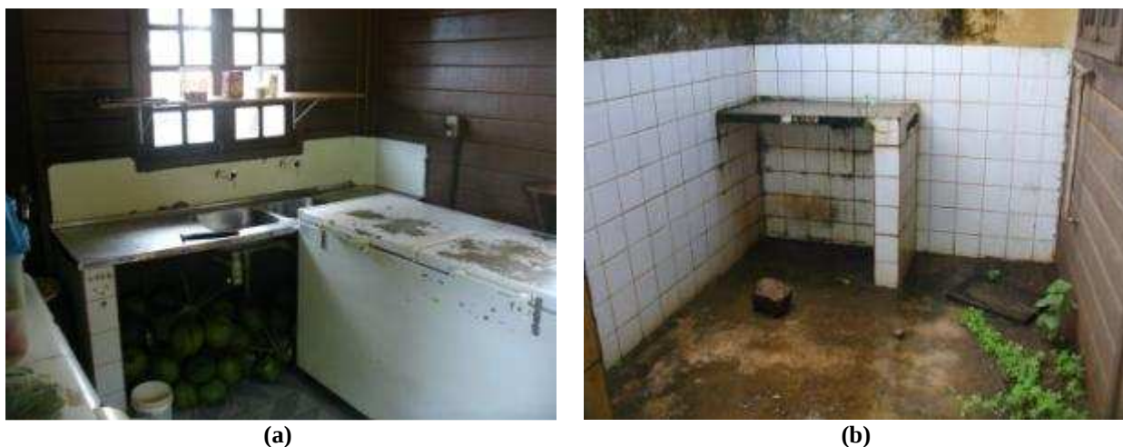
Figura 26: Em (a), vista interna do Bar do PIC do Sancho, com prateleira em local inadequado na frente da janela; e em (b), vista da área de apoio que não está sendo utilizada, cuja porta de acesso permanece sempre fechada. Observa-se o estado de deterioração e abandono do ambiente, com crescimento de vegetação nas fendas do piso e limo acumulado.
