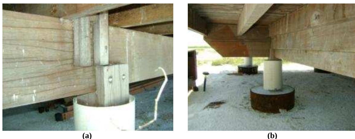
Figura 43: Em (a), detalhe da junção de um pilarete com uma viga do tipo simples da base da edificação. Observa-se o aspecto acinzentado da madeira com sulcos mais evidenciados sendo que os elementos metálicos (parafusos) estão íntegros; e em (b), vista de um dos pilares das fundações da Estação, destacando-se que uma parte da viga do piso foi pintada com stain .
