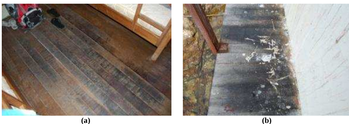
Figura 70: Em (a), piso interno do dormitório apresentando desgaste da pintura nas áreas de maior circulação; e em (b), vista do piso do deck lateral da Estação, área que sofre a incidência direta do sol e está mais exposta à ação da névoa salina. Observam-se, também, manchas de tinta da última pintura das paredes.
