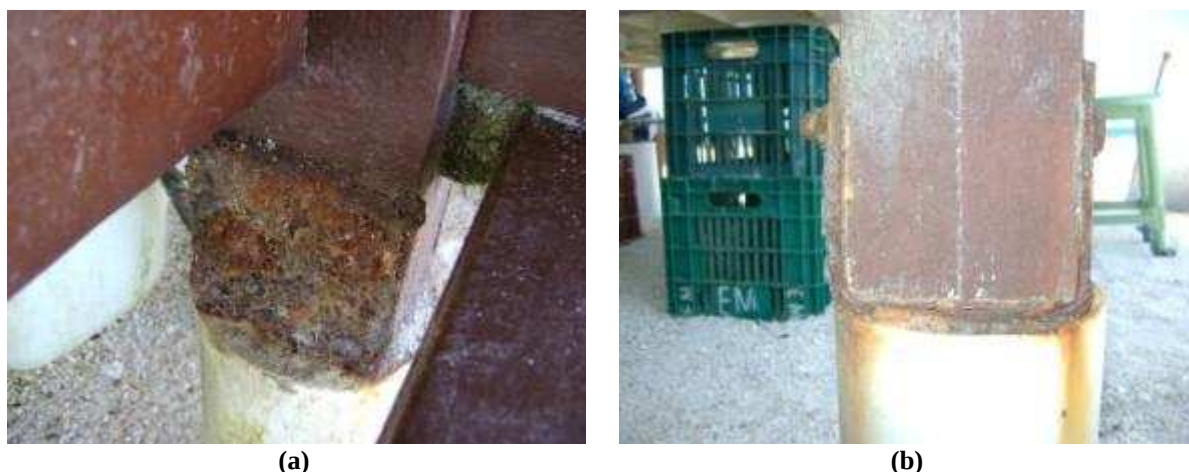
Figura 42: Vistas de um mesmo perfil em “U” e parafusos utilizados para encaixe e fixação de um dos pilares de madeira na base em concreto, em estado avançado de corrosão.
