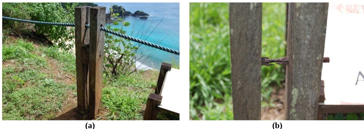
Figura 22: Em (a), pilarete de um guarda-corpo em bom estado geral. Observa-se que o parafuso de junção dos pilares está protegido por uma peça de conexão; e em (b), detalhe do parafuso de junção das peças bastante avariado pela corrosão.
