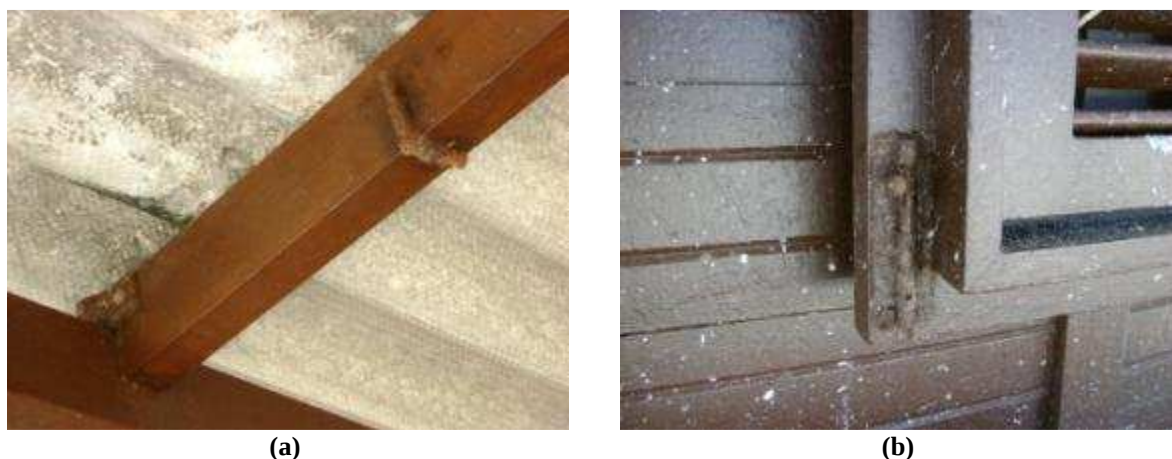
Figura 44: Em (a), detalhe do madeiramento da cobertura da Primeira Estação. Observa-se estado geral da madeira satisfatório em contraste com o processo corrosivo acentuado de um dos ganchos metálicos de fixação das telhas; e em (b), detalhe do trinco de fechamento de uma das janelas, inoperante devido ao grau avançado de corrosão e recobrimento com tinta.
