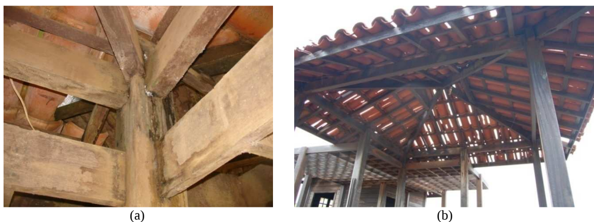
Figura 23: Em (a), ponto de junção entre cobertura e pergolado, constatando-se a falta de algumas telhas que ocasionam a infiltração de água e destruição paulatina das peças estruturais; e em (b), aspecto do telhado do PIC Duplo da Praia das Caieiras apresentando várias falhas na cobertura. A razão da formação dessas fendas nas telhas ainda não foi esclarecida, mas segundo relato dos fiscais do parque, suspeita-se de processo corrosivo sofrido por componentes químicos do material. Contudo, trata-se de um caso isolado.
