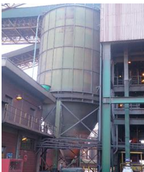
Figura 28 - Silo de armazenagem de bentonita ("sorvetão").
