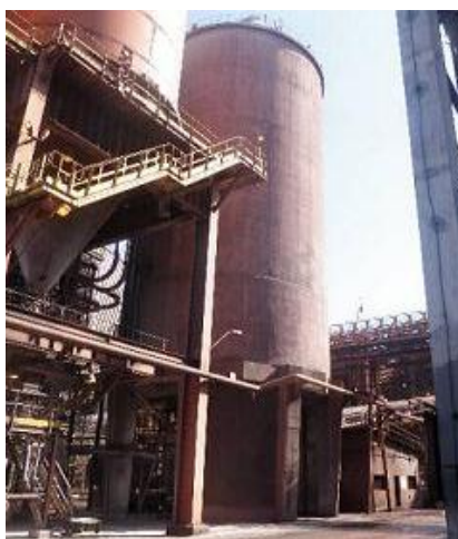
Figura 33 - Silo de armazenagem de carvão bruto no cliente.
