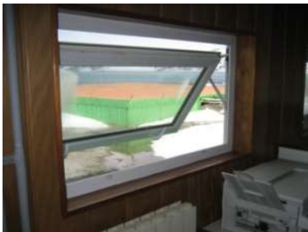
Figura 18. Janela da biblioteca mantida aberta durante alguns períodos do dia para permitir a renovação do ar.
