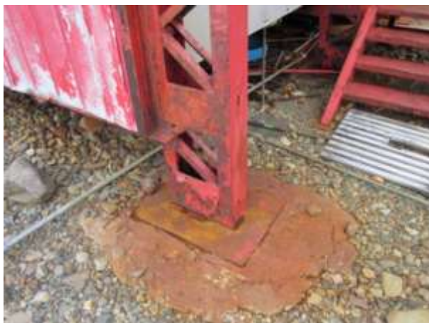
Figura 32. Base da estação com perceptíveis indicativos de corrosão.
