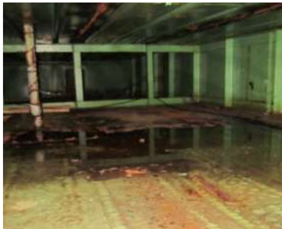
Figura 15. Acúmulo de água entre cobertura e forro interno da EACF.
