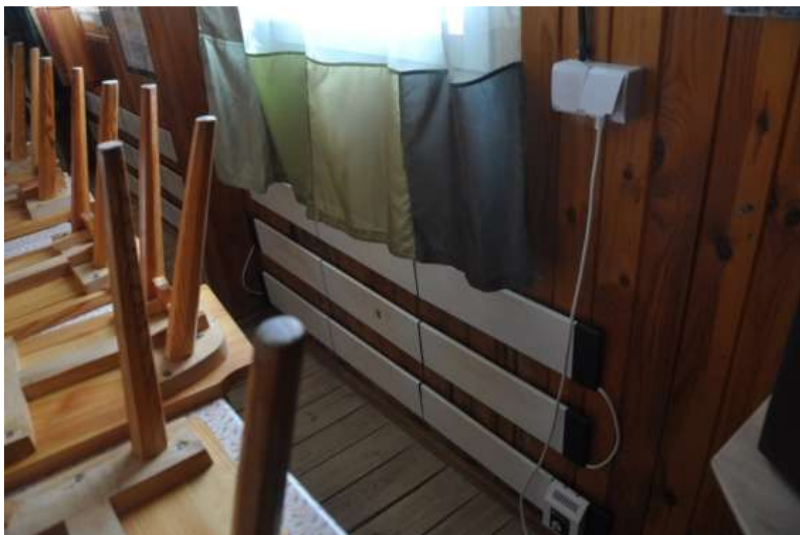
Figura 29. Sistema de aquecimento interno com equipamentos elétricos.
