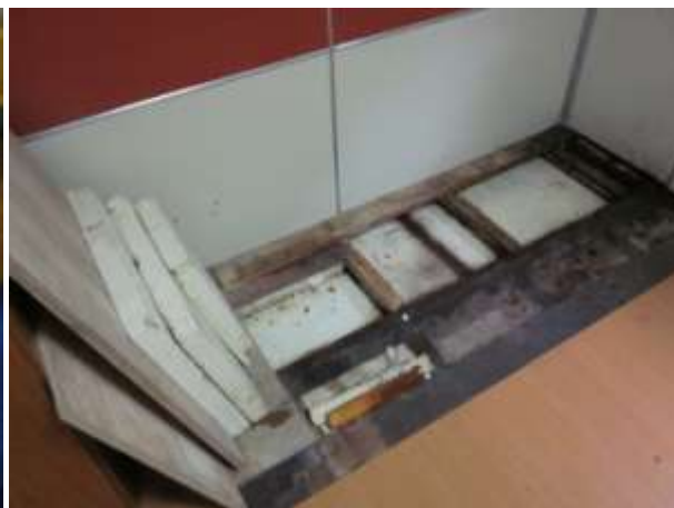
Figura 17. Piso abaixo da cama do camarote 9, com perceptíveis sinais de umidade.
