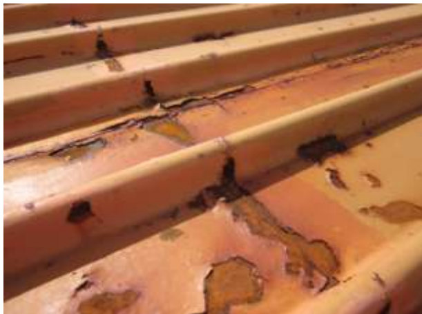
Figura 14. Sinais de corrosão na cobertura da EACF em fevereiro de 2011.
