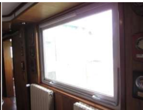
Figura 21. Janela da sala de estar com vedação improvisada dos vãos formados entre as partes fixa e móvel da esquadria.
