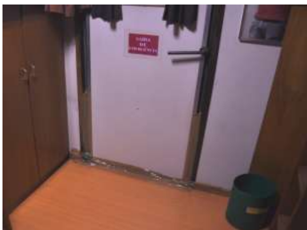
Figura 20. Porta de emergência no camarote 3, com vedação improvisada dos vãos formados entre os painéis e a esquadria.
