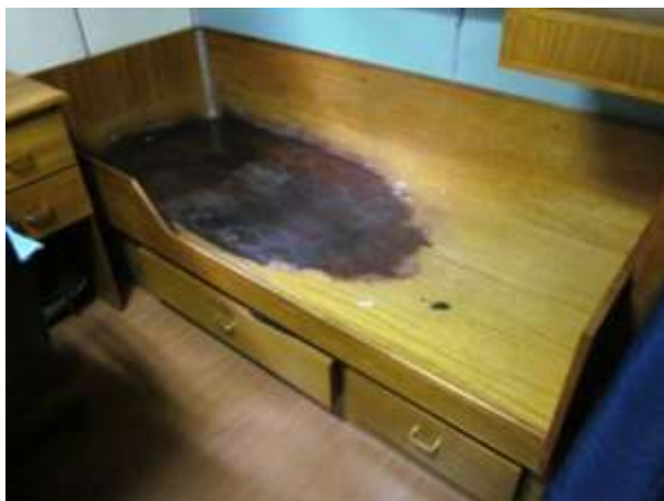
Figura 16. Cama do camarote 7 com indícios de umidade e mofo..
