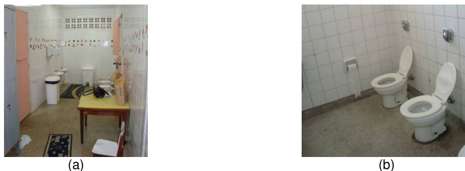
Figura 25: Banheiros do CMEI 2, observando-se em (a) a inadequação ergonômica do mobiliário e em (b) a falta de privacidade das crianças
