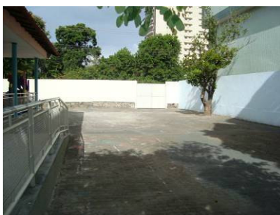
Figura 20: Pisos danificados e bueiros entupidos
