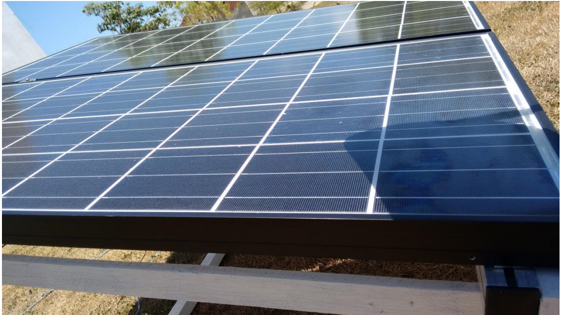
Figura 31 - Testes em módulo fotovoltaico com uma célula totalmente sombreada
