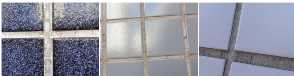
Figura 5.130 – Fissuras nos rejuntas de CER3 (Dt.j3)
