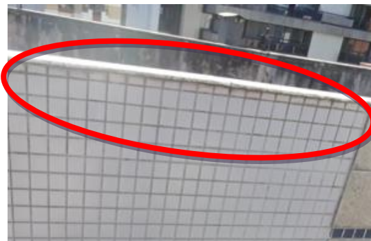
Figura 5.145 – Manchas e sujeiras no topo de CER3
