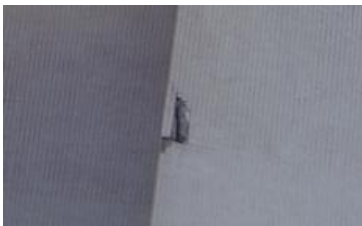
Figura 5.111 – Desagregação do concreto e corrosão em CER2
