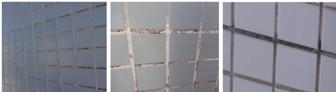
Figura 5.129 – Alteração de cor nos rejuntas de CER3 (Dt.j2)
