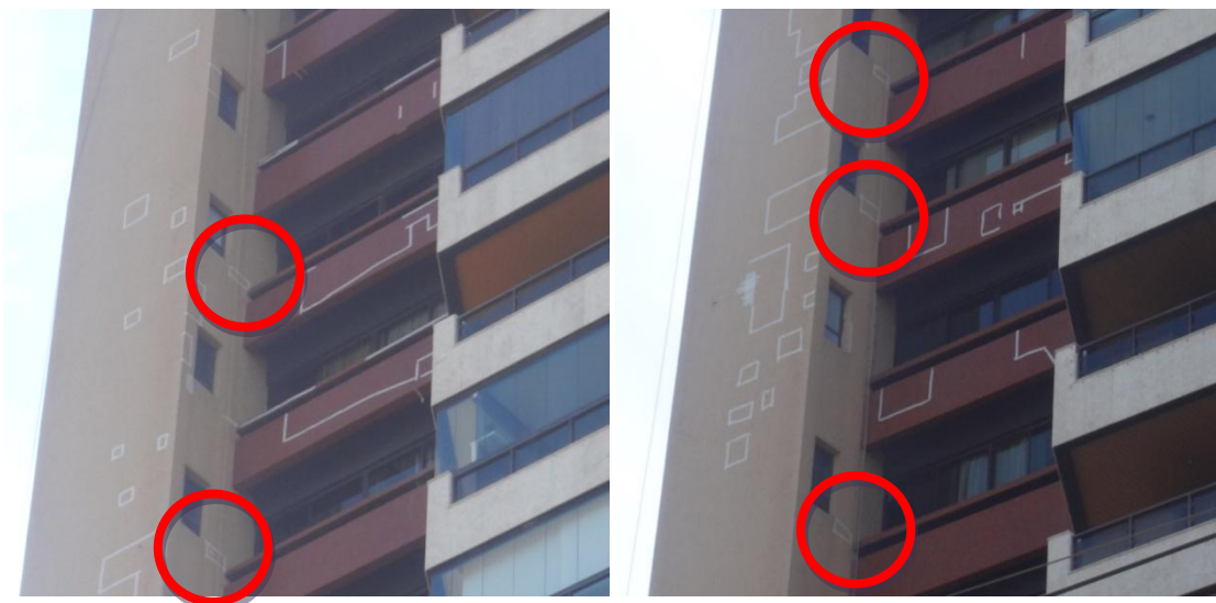
Figura 5.117 – Fissuras na argamassa nos locais de desprendimento cerâmico
