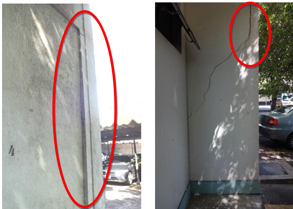
Figura 5.69 – Fissuras nos cantos e extremidades de ARG3 no térreo
