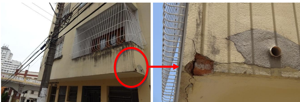
Figura 5.12 – Descolamento do reboco na sacada
