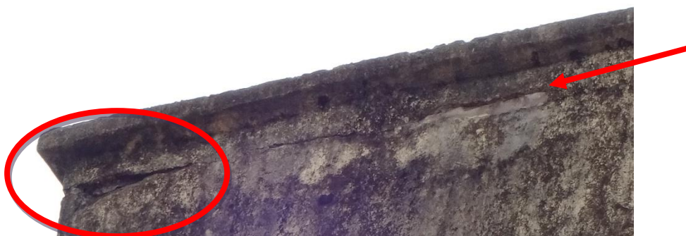
Figura 5.20 – Topo do edifício ARG1 com fissura e descolamento do reboco
