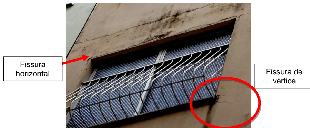
Figura 5.36 – Fissura horizontal acima da janela e de vértice em ARG2
