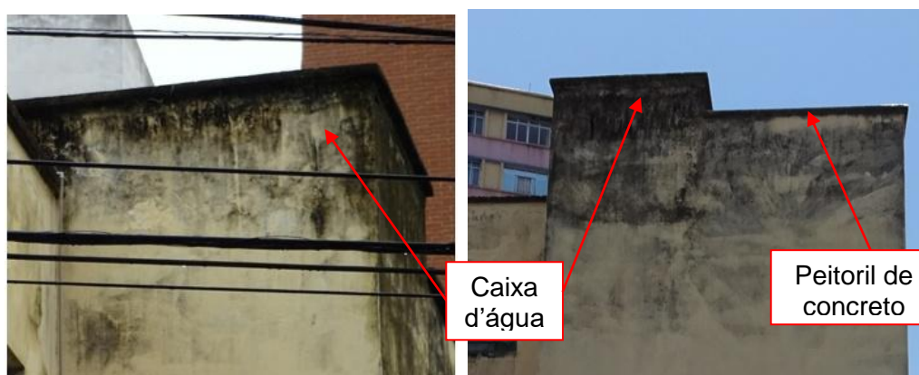
Figura 5.19 – Topo do edifício ARG1 com umidade e manchas
