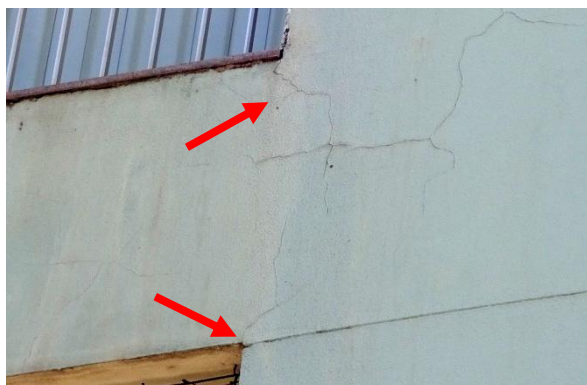
Figura 5.65 – Fissuras de vértice em ARG3
