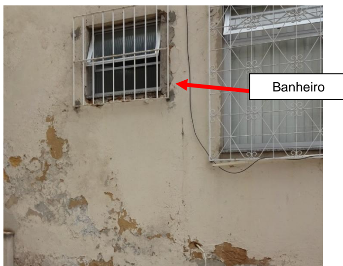
Figura 5.34 – Umidade e descolamento da pintura em ARG2
