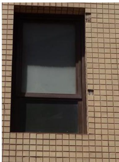
Figura 5.107 – Queda das pastilhas de CER2 nas aberturas
