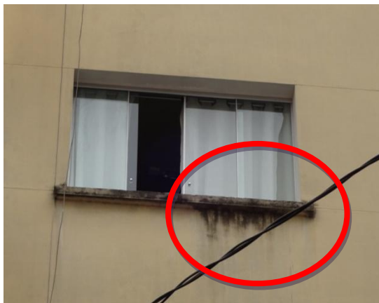
Figura 5.8 – Manchas e umidade abaixo do peitoril de concreto
