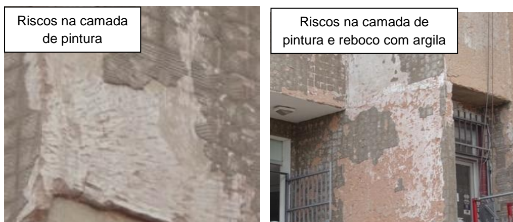
Figura 5.99 – Riscos na pintura e argila no reboco
