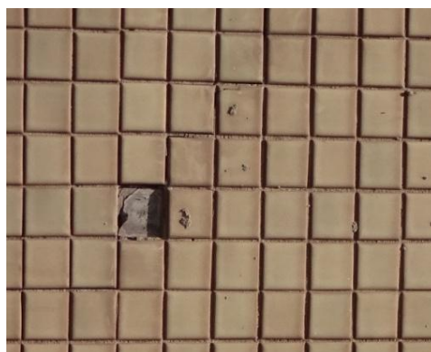
Figura 5.104 – Queda das pastilhas de CER2 nas paredes contínuas
