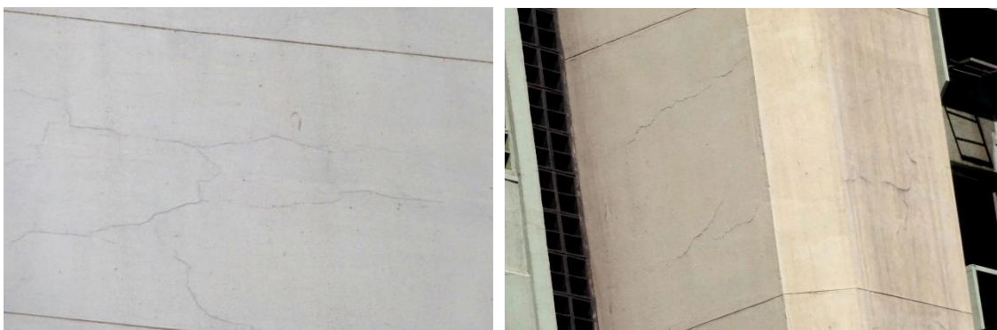
Figura 5.59 – Fissuras nas paredes contínuas de ARG3
