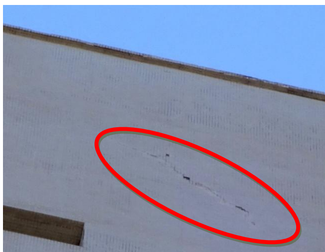
Figura 5.114 – Fissura no topo de CER2
