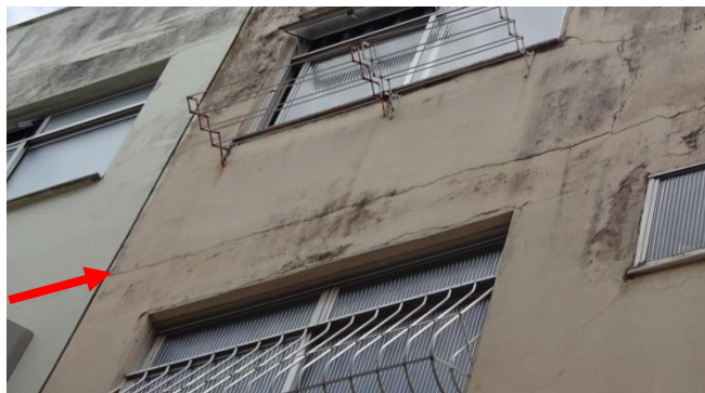
Figura 5.41 – Fissura na transição entre pavimentos de ARG2
