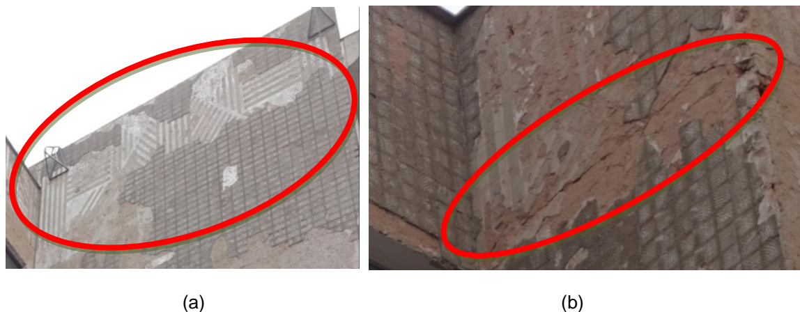
Figura 5.100 – Marcas na fachada e fissura em CER1
