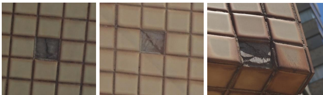
Figura 5.116 – Fissuras na argamassa nos locais de desprendimento cerâmico
