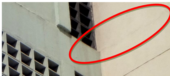
Figura 5.75 – Fissuras na transição entre pavimentos de ARG3
