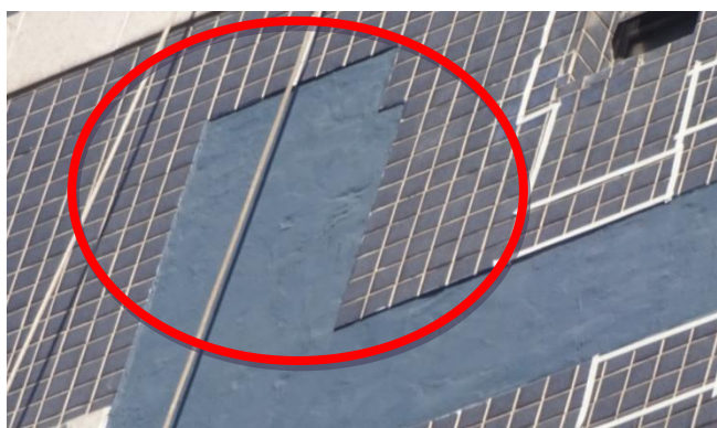
Figura 5.135 – Desplacamento cerâmico CER3 (D.1_a)
