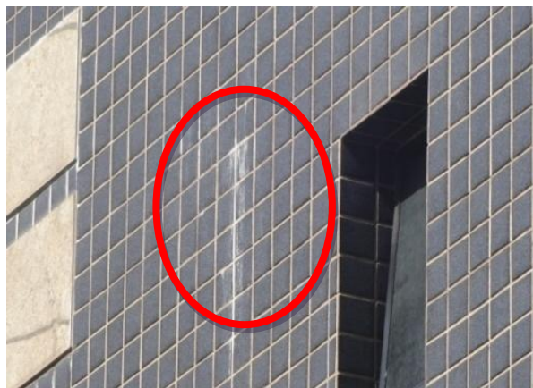
Figura 5.143 – Eflorescência nos rejuntas de CER3
