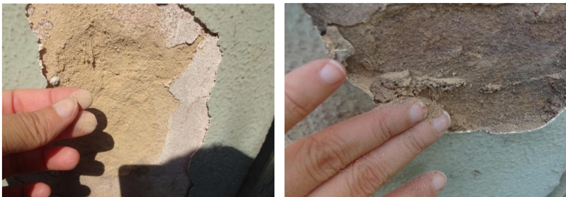
Figura 5.84 – Textura solta do reboco de ARG3
