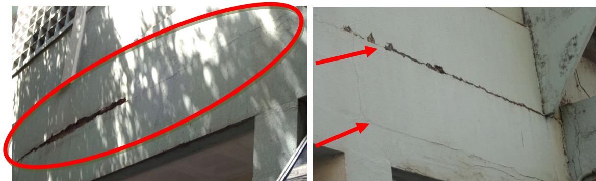
Figura 5.76 – Fissuras na transição entre pavimentos de ARG3
