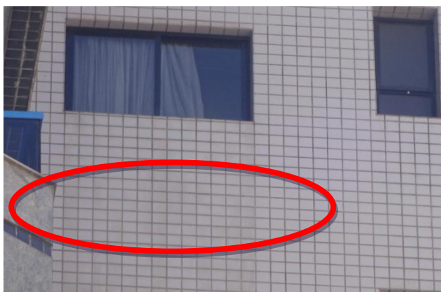
Figura 5.134 – Manchas e sujeiras nas paredes contínuas de CER3
