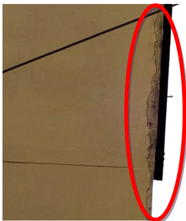
Figura 5.14 – Fissura na região de cantos e extremidades das fachadas
