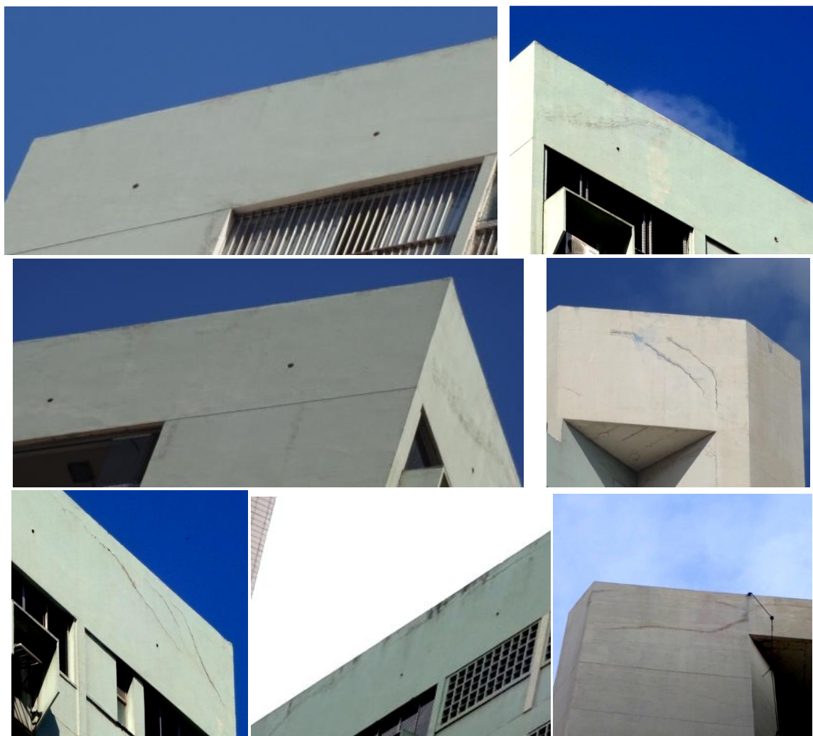
Figura 5.79 – Fissuras, manchas e sujeiras no topo de ARG3
