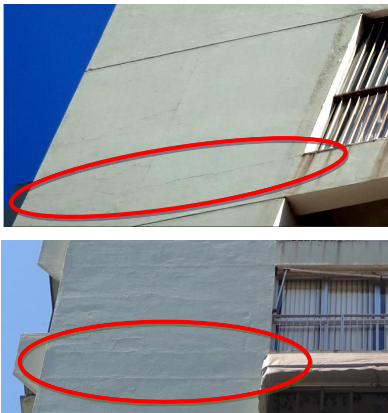
Figura 5.74 – Fissuras na transição entre pavimentos de ARG3
