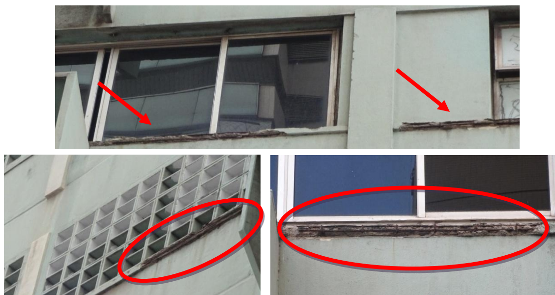
Figura 5.67 – Corrosão das armaduras e desagregação do concreto nas aberturas de ARG3
