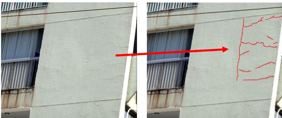
Figura 5.60 – Fissuras na fachada leste de ARG3
