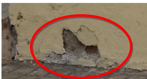
Figura 5.4 – Descolamento do reboco ao nível do solo da fachada su-sudeste
