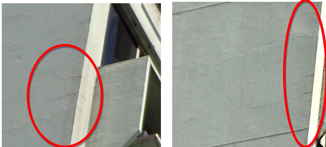
Figura 5.70 – Fissuras nos cantos e extremidades de ARG3
