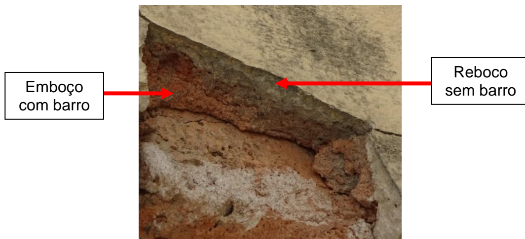
Figura 5.28 – Parte do reboco deslocado, permitindo a visualização das camadas do revestimento
