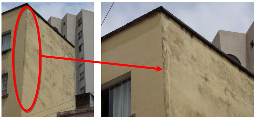
Figura 5.15 – Fissuras verticais no canto da fachada
