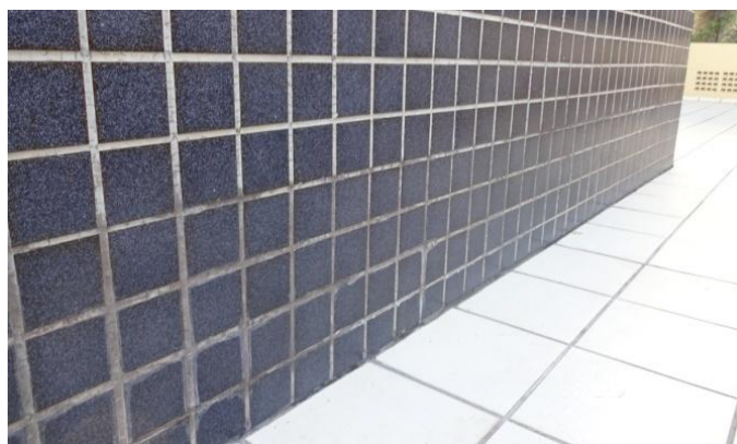
Figura 5.132 – Manchas e sujeiras no nível do solo de CER3
