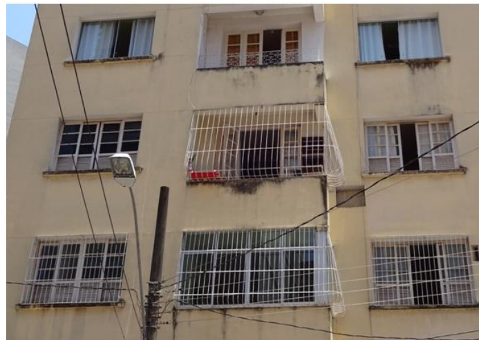
Figura 5.11 – Sacadas com manchas e umidade
