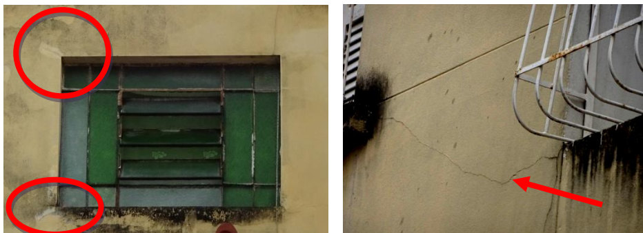
Figura 5.9 - Fissuras de vértice nas aberturas
