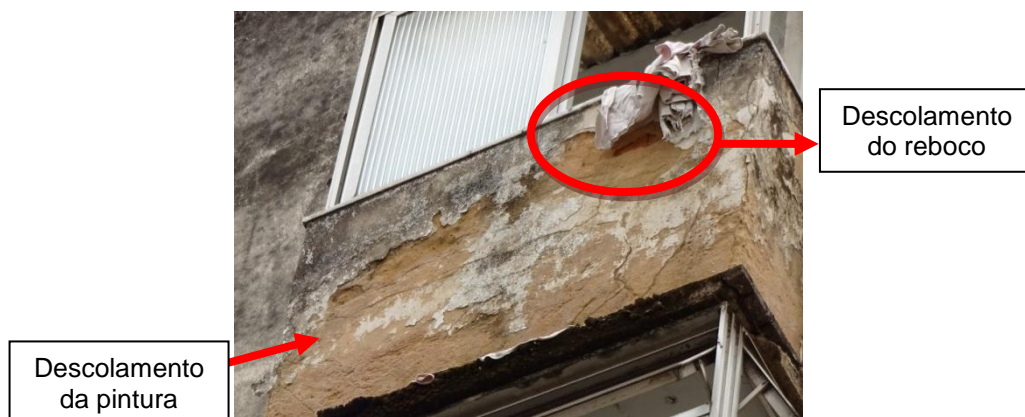
Figura 5.38 – Descolamento da pintura e do reboco em uma sacada de ARG2
