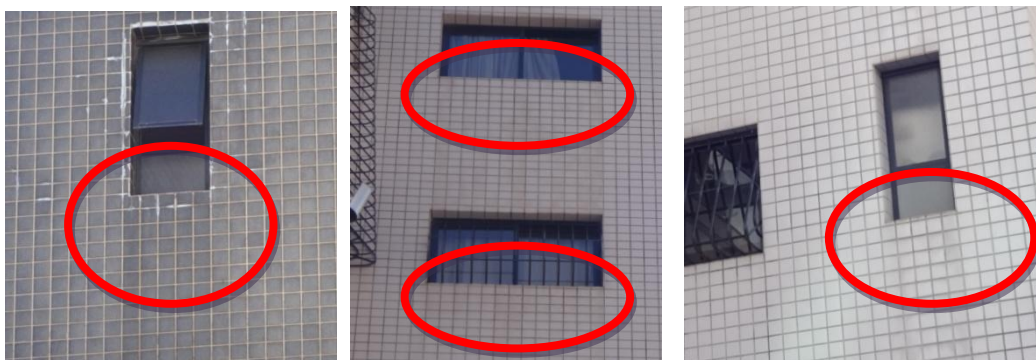
Figura 5.138 – Manchas e sujeiras abaixo das aberturas de CER3
