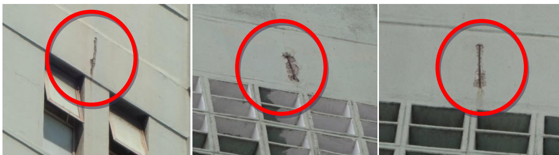
Figura 5.77 – Fissuras na transição entre pavimentos de ARG3
