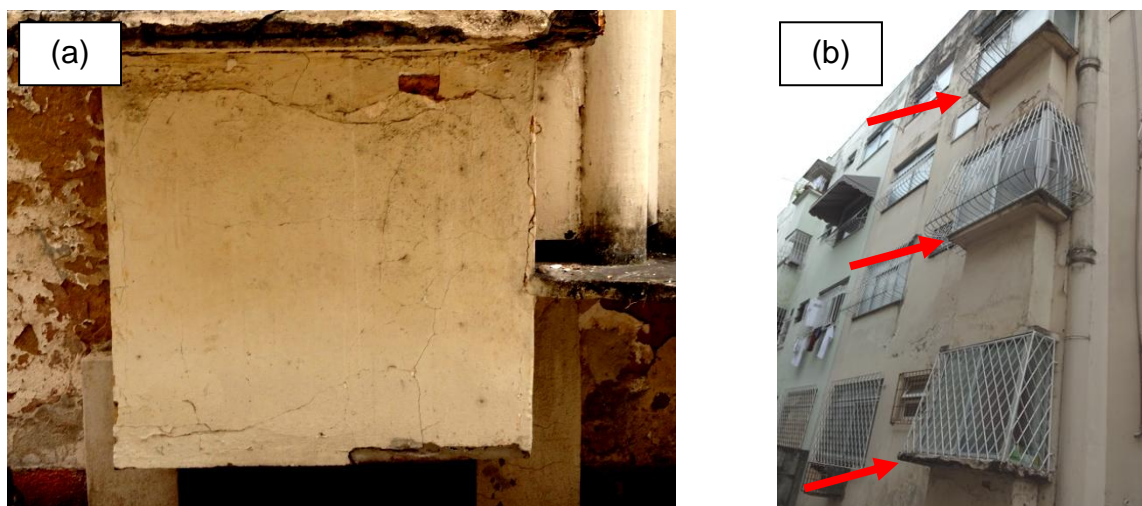
Figura 5.39 – Fissuras em uma sacada e locais de corrosão e desagregação do concreto em ARG2
