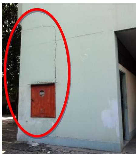
Figura 5.62 – Fissuras na fachada oeste de ARG3
