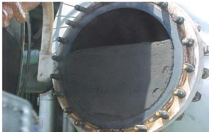
Figura 4 – Acúmulo de areia em um separador, plataforma P-25, Bacia de Campos – RJ. Fonte: Castro (2010).
