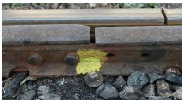
Figura 1.3: Espaço entre os trilhos do trem necessários para impedir a deformação no caso do aumento de temperatura.
