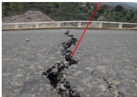
Figura 3.1: Ilustração de uma ponte com rachaduras.
