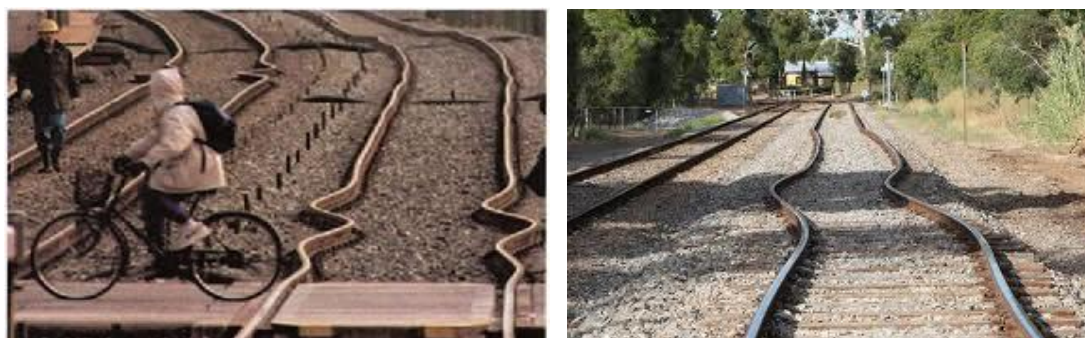
Figura 1.4: Trilhos deformados devido à falta das juntas de dilatação.
