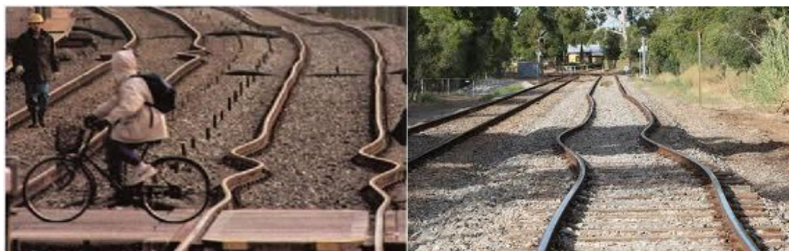
Figura 3.2: Deformação sofrida pela linha férrea sem as juntas de dilatação.
