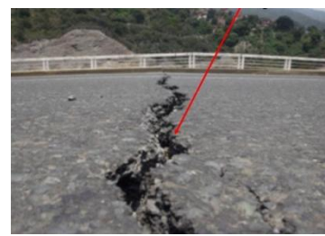
Figura 1.1-c: Mostra o que acontece quando uma ponte é construída sem as juntas de dilatação.
