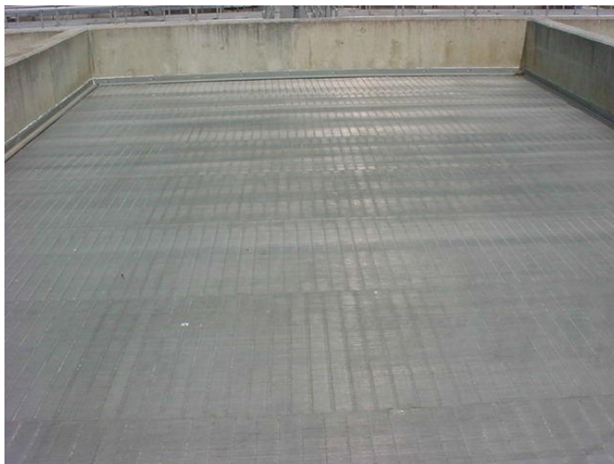
Figura 7 – Leito de secagem por blocos drenantes aberto. Fonte: Gravity Flow Systems Southwest, Inc.
