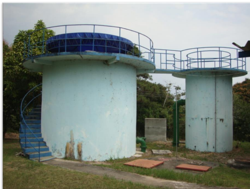
Figura 18 – ETA de Coqueiral Fonte: acervo do autor
