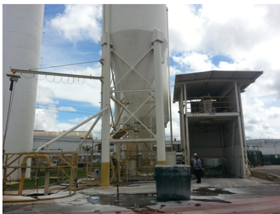
Figura 72. Água residual bombeada até o silo
