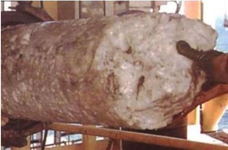
Figura 6 – Hidrato coletado na abertura do recebedor de pig
