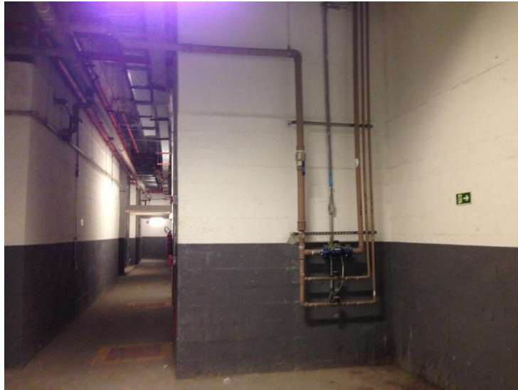
Figura 17 – Hidrômetros instalados no corredor de serviço
