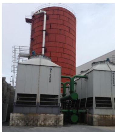
Figura 14 - Torre de Resfriamento
