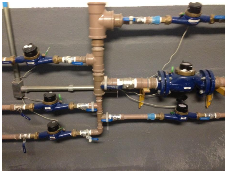
Figura 18 – Hidrômetros instalados na garagem
