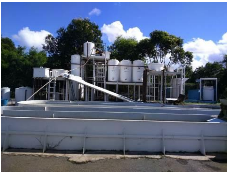
Figura 5 - Piloto da Estação de Tratamento de Esgoto Sanitário
