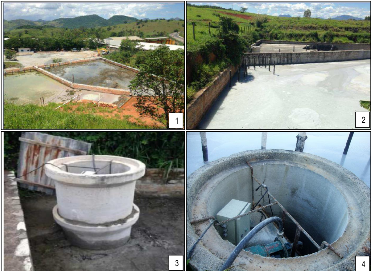
Figura 14 – Demonstrativo do leito secante de decantação e reservatório acumulador de água filtrada com motor para bombeamento de água para reutilização.
