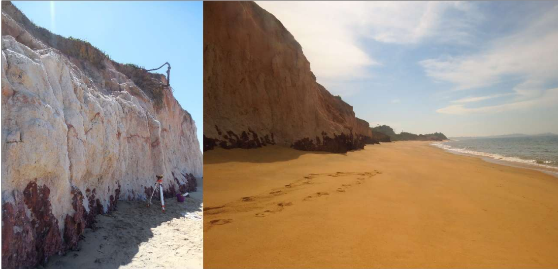
Figura 2. 12 - Foto tirada em campo (2017) ilustrando a ausência de talus na base da Falésia NorteFalésia NorteFalésia Norte.
