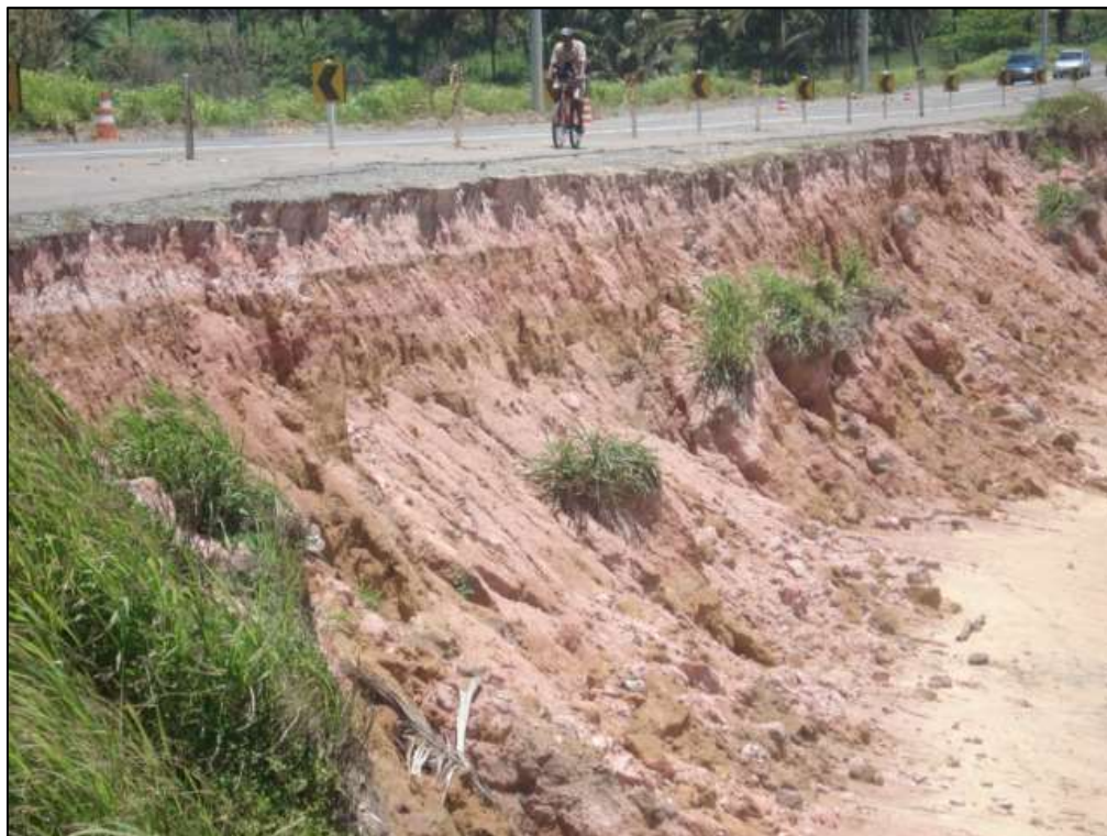
Figura 2. 7 - Processos erosivos constatados na área de estudo danificando estrutura rodoviária (ES-060).
