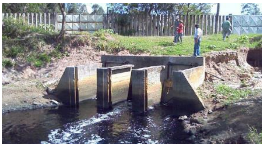
Figura 6: Comporta que liga o Canal de Guaranhuns ao Rio Jucu. Fonte: VILA VELHA, 2011.
