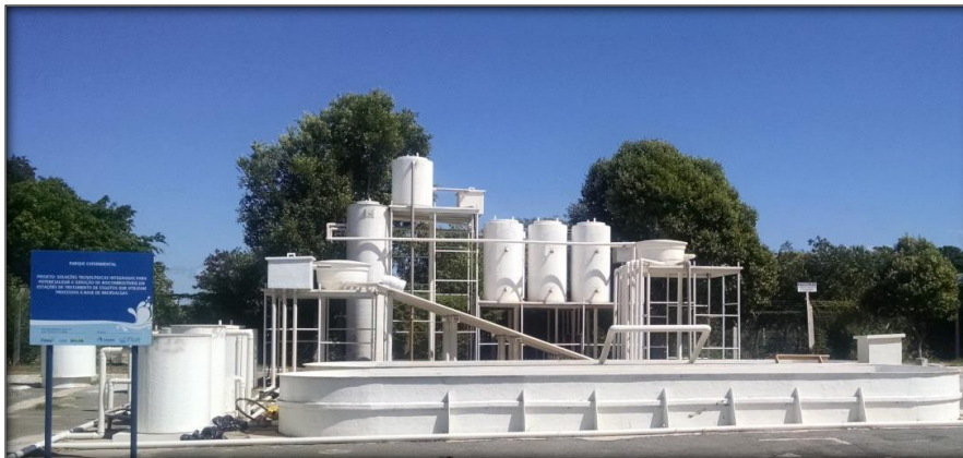
Figura 8- Escala piloto para o tratamento de esgoto sanitário
