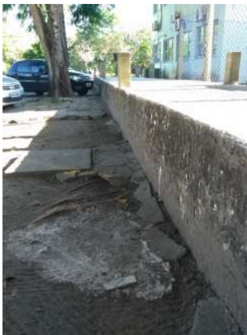
Figura 33 - Risco de queda em rampa
