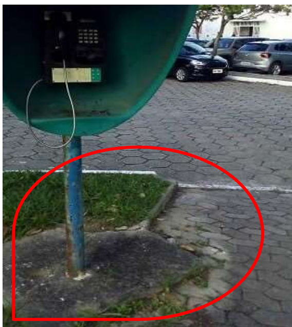
Figura 61 - Orelhão e placa de cimento
