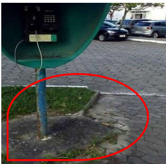
Figura 20 – Orelhão e placa de cimento
