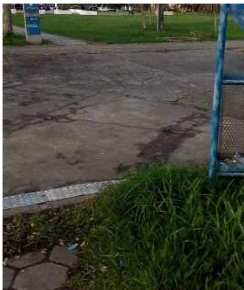
Figura 59 - Grama invadindo a calçada
