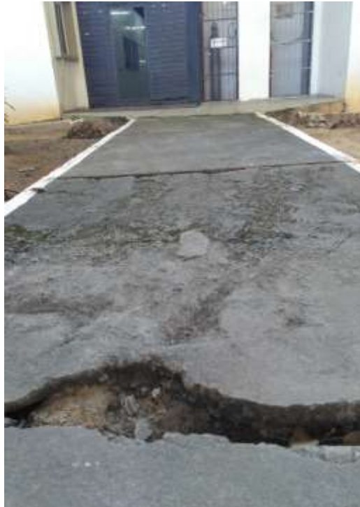
Figura 31 - Fissura com buraco no CT
