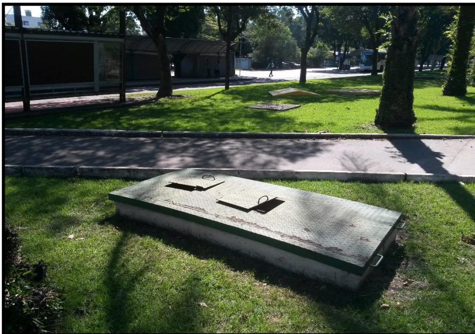
Figura 8 – Abrigo do Hidrômetro Principal Fonte: Vale S.A. (2018).
