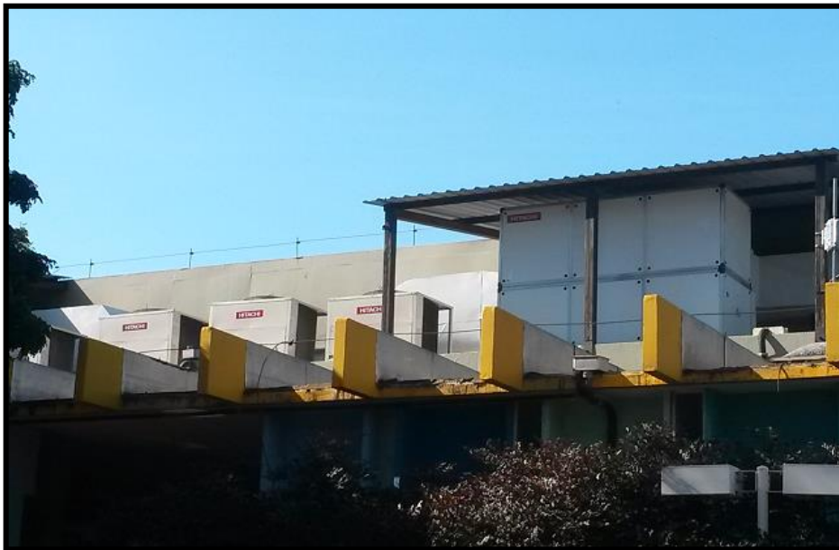
Figura 10 – Unidades Condensadoras Fonte: Gerência de Infraestrutura da Vale S.A., (2018).
