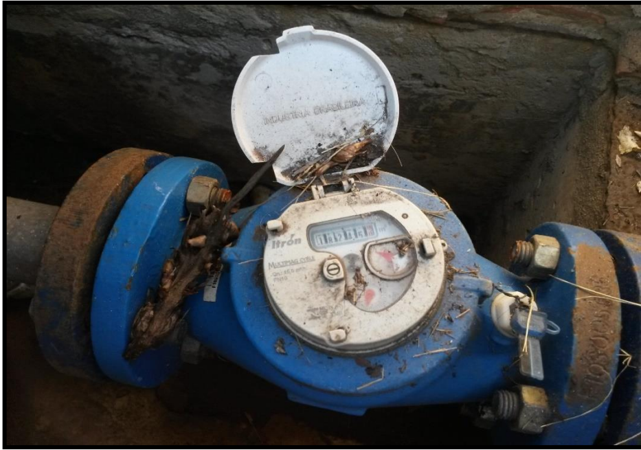
Figura 7 – Vista do Hidrômetro Principal do Restaurante Central Fonte: Vale S.A. (2018).
