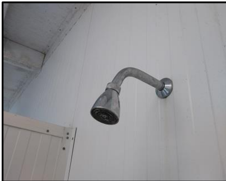
Figura 24 – Chuveiro com fechamento automático Fonte: Elaborado pelo autor (2018).
