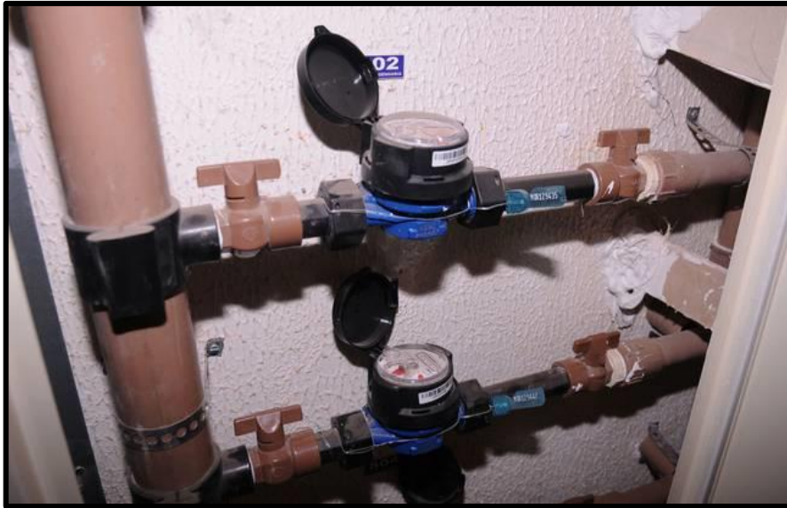
Figura 13 – Hidrômetros instalados no Restaurante Central Fonte: Elaborado pelo autor (2018).
