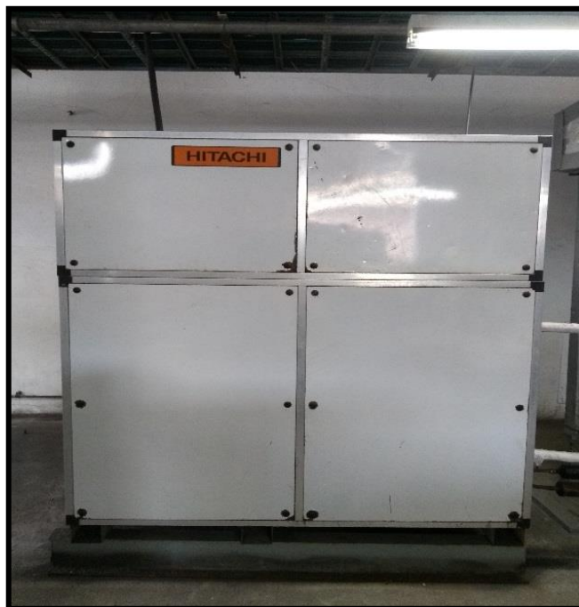
Figura 19 – Unidade Condensadora nº 04 Fonte: Elaborado pelo autor (2018).
