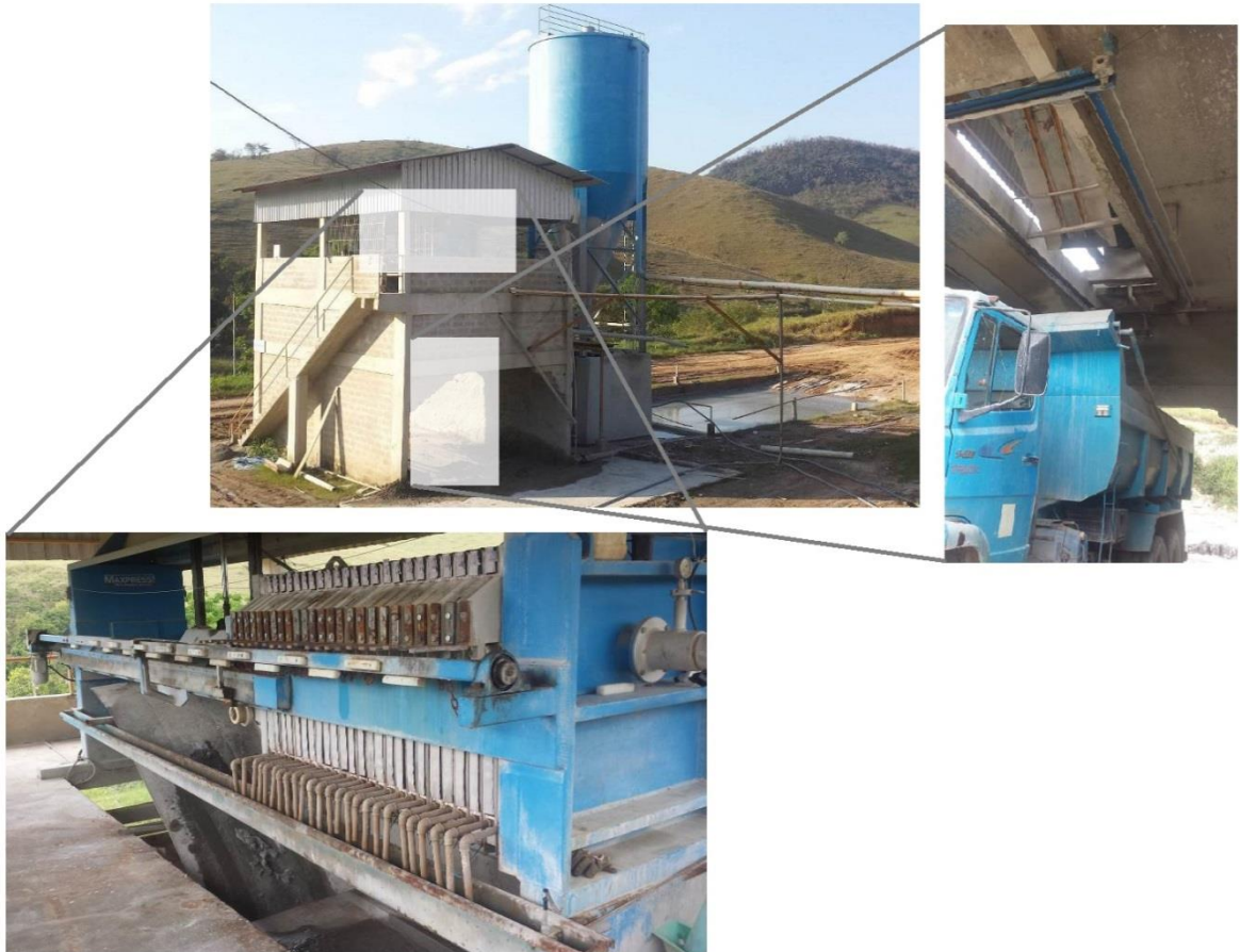
Figura 7 – Sistema de desidratação do RBRO por meio de filtro prensa da AAMOL.
