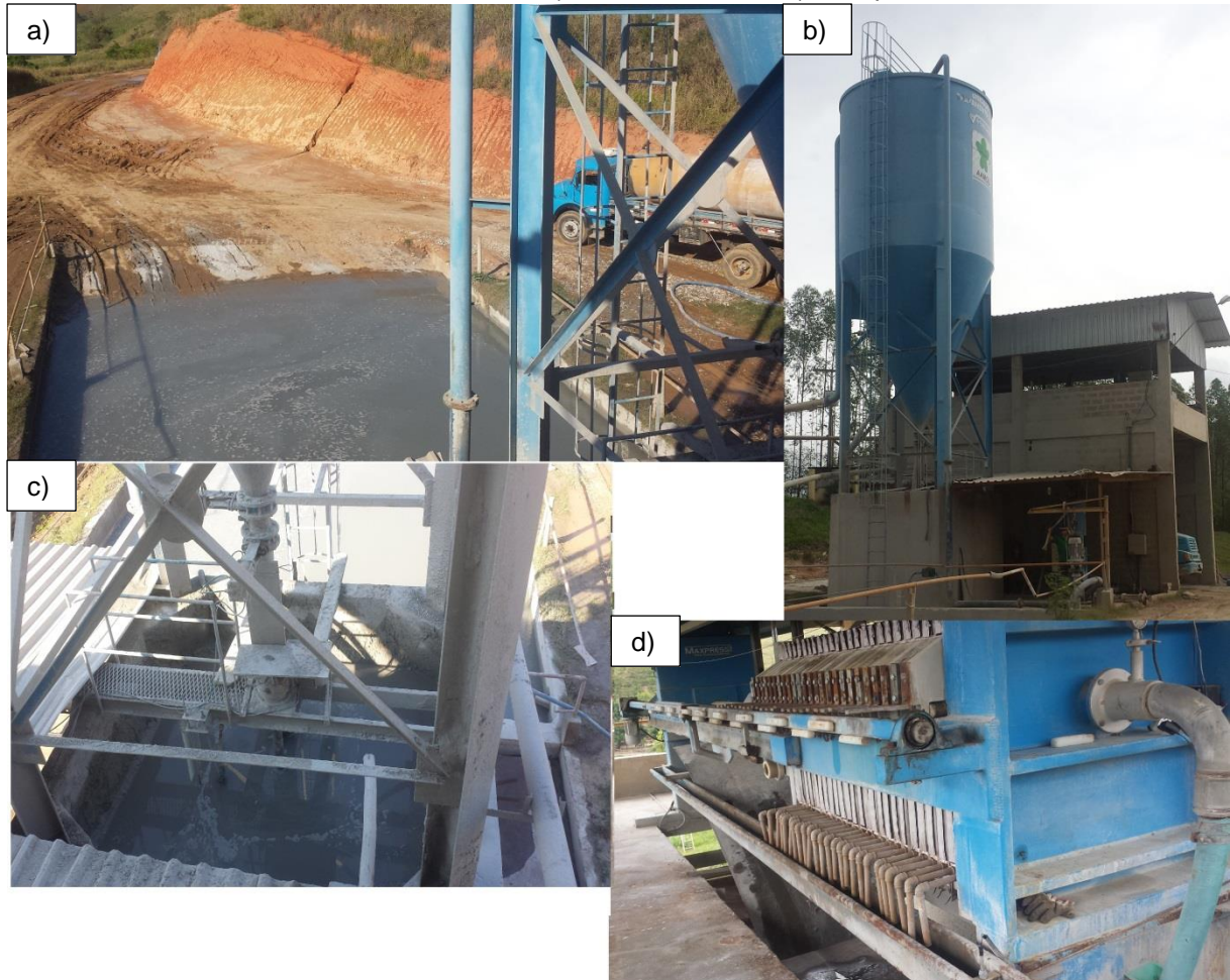
Figura 13 – Processo de desidratação pelo filtro prensa. a) Lama fluida no tanque de decantação; b) sedimentador vertical; c) baterdor de lama; d) filtro-prensa.
