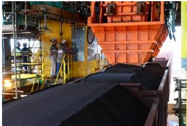
Figura 5: Exemplo de carregamento de minério de ferro por silo
