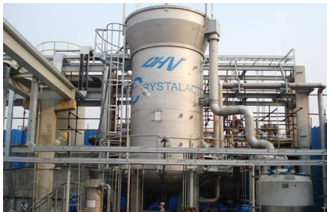
Figura 31 - Cristalizador instalado em uma indústria química na cidade de Nanjing, China. Fonte: Royal HaskoningDHV (2018).
