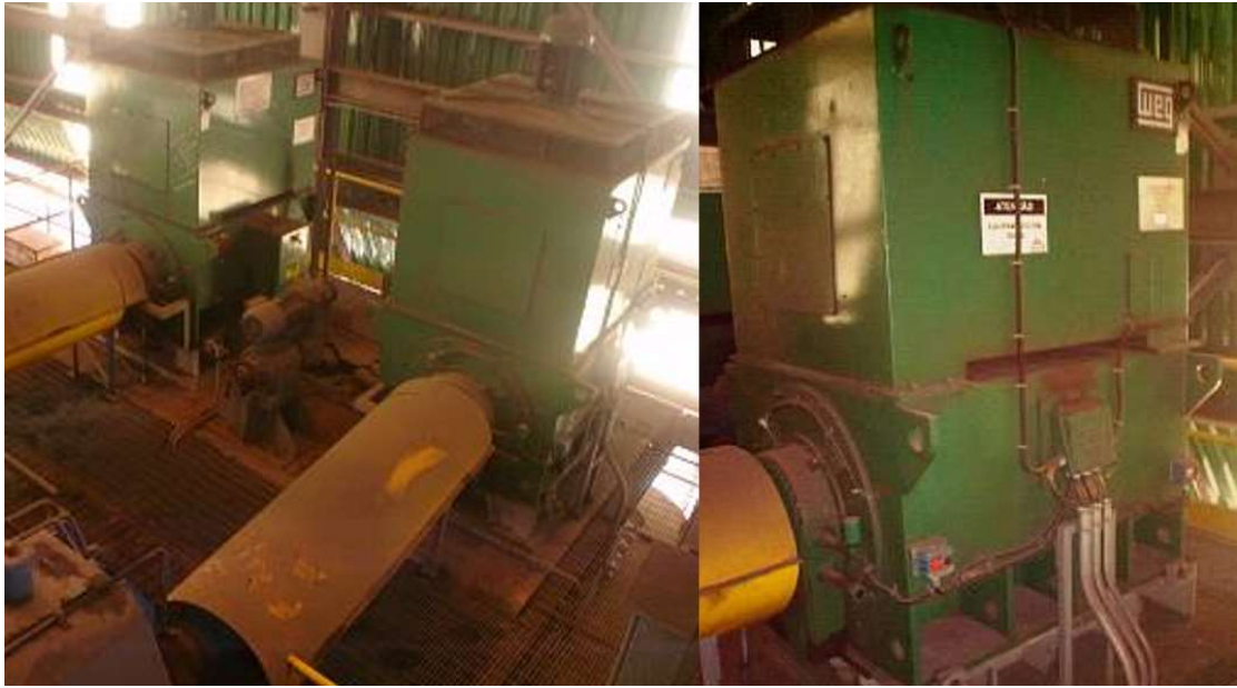
Figura 21 – Motores de Acionamento da HPGR 3PR7.
