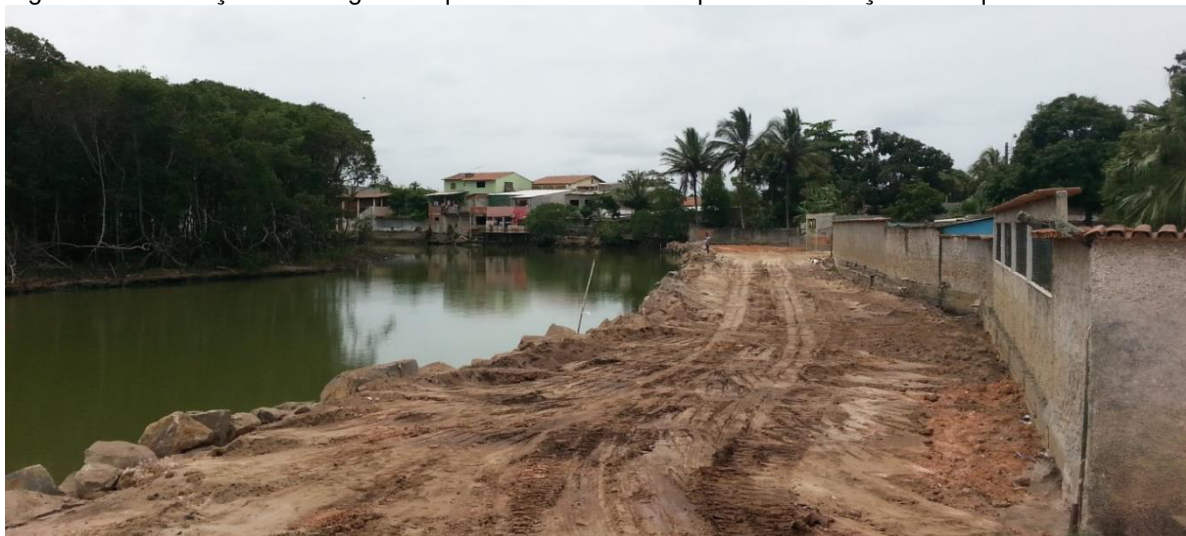
Figura 105: Elevação da margem esquerda do Rio Jacaraípe via construção de dique com rochas.
