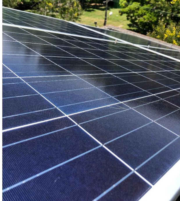
Figura 7 Painel fotovoltaico instalado no prédio do CT VI
