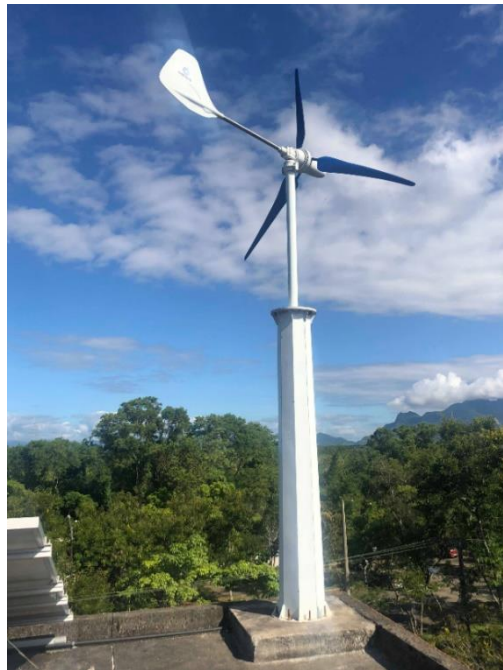
Figura 11 Turbina eólica instalada no prédio do CT VI
