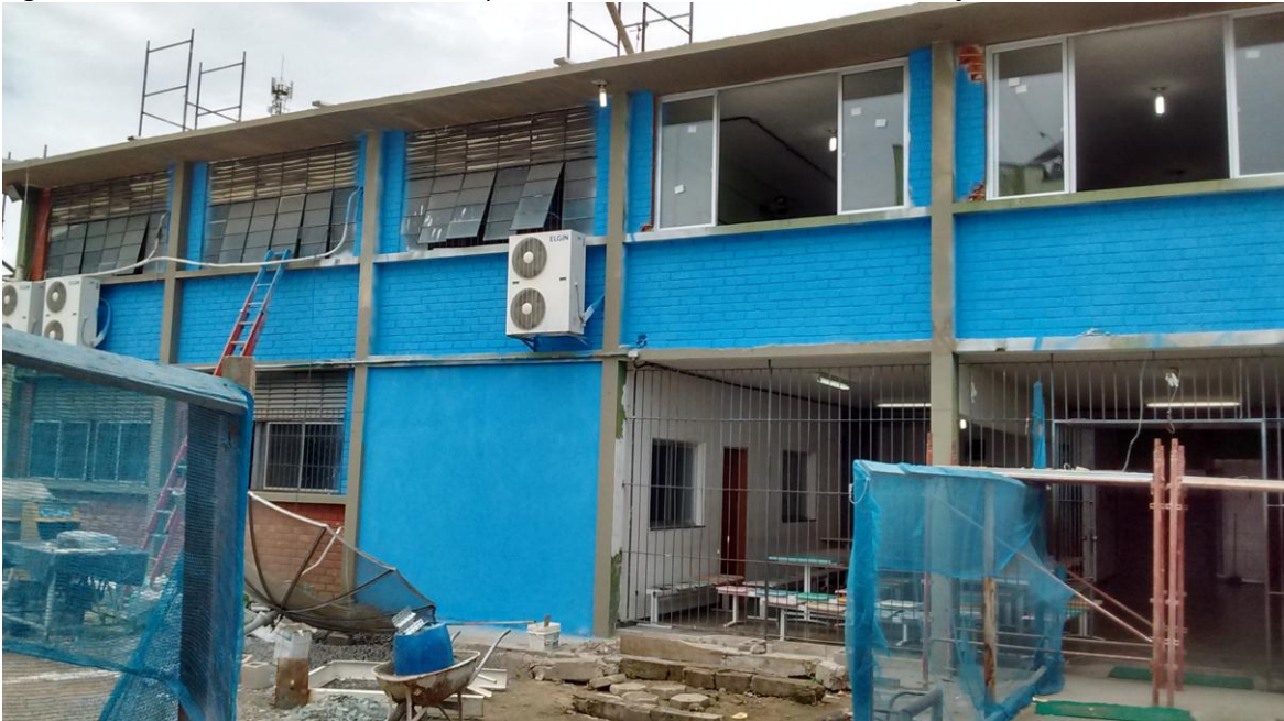
Figura 3 – Pátio sendo utilizado como depósito de materiais diversos de construção civil
