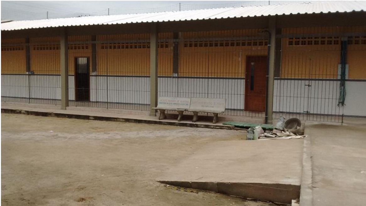
Figura 4 – Presença de entulhos próximos ao acesso dos estudantes à sala de aula
