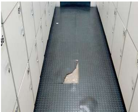
Fotografia 10 - Piso antiderrapante soltando
