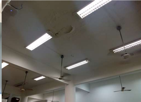
Fotografia 4 - Teto da Biblioteca com infiltrações
