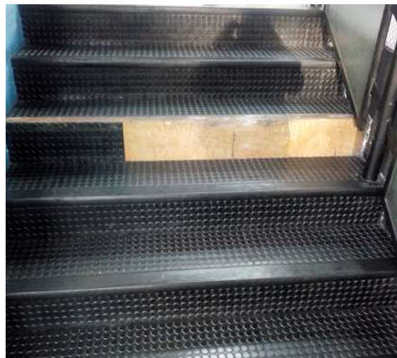
Fotografia 9 - Piso antiderrapante soltando
