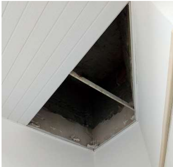
Fotografia 6 - Buraco no teto do banheiro masculino
