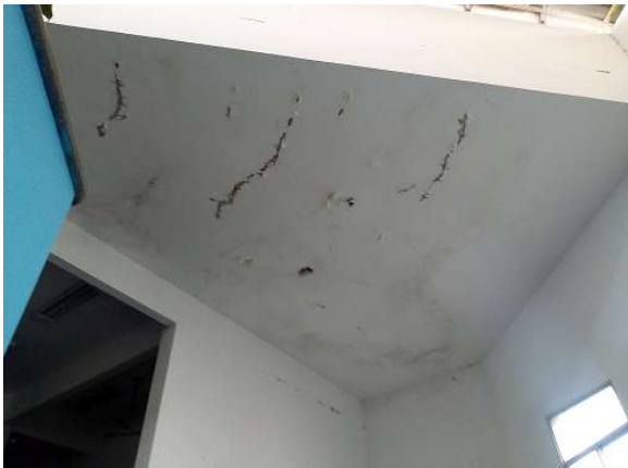
Fotografia 3 - Teto da Biblioteca com infiltrações
