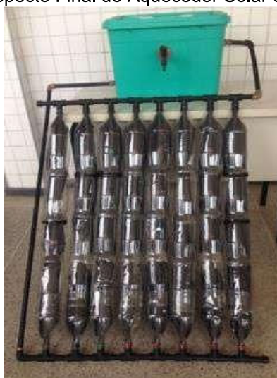
Figura 22 – Aspecto Final do Aquecedor Solar de Baixo Custo.
