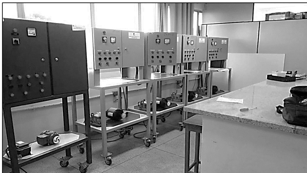
IFES, Campus São Mateus Laboratório de Instalações Elétricas Fonte: O autor
