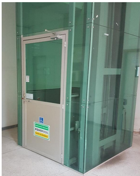
Figura 11 - Elevador no edifício Audiovisual do CAR
