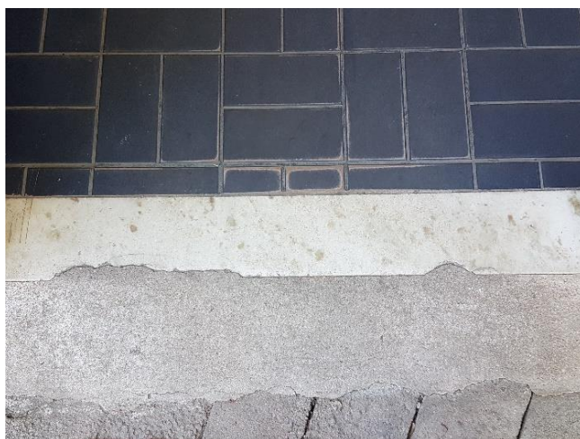
Figura 7 - Desnível no prédio da Administração do CCE
