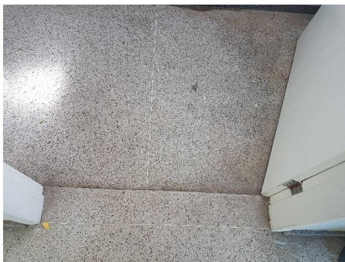
Figura 9 - Desnível no acesso ao sanitário do Anexo ao CEFD
