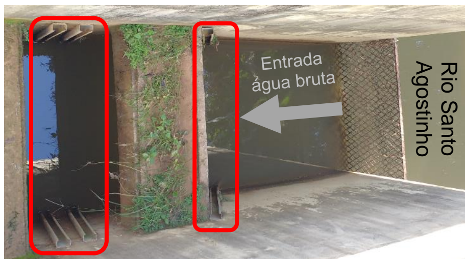
Figura 18 – Ausência telas e gradeamento na captação do Rio Santo Agostinho
