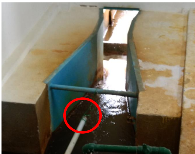
Figura 20 – Ausência da calha de dispersão do coagulante
