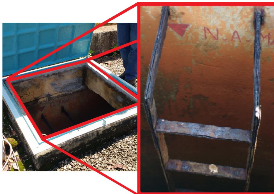
Figura 23 – Escadas deterioradas no interior dos reservatórios de água tratada
