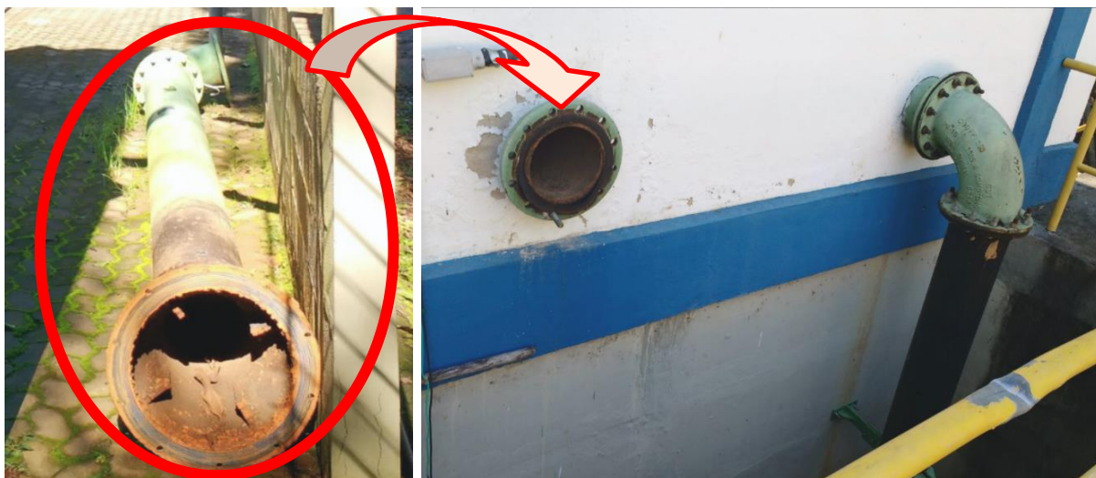
Figura 19 – Bomba reserva inoperante na captação do Rio Santo Agostinho
