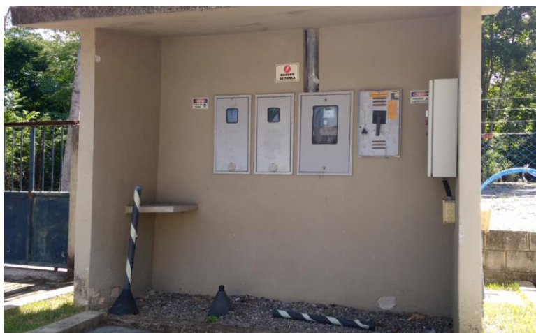
Figura 24 – Ausência de gerador de energia elétrica na ETA
