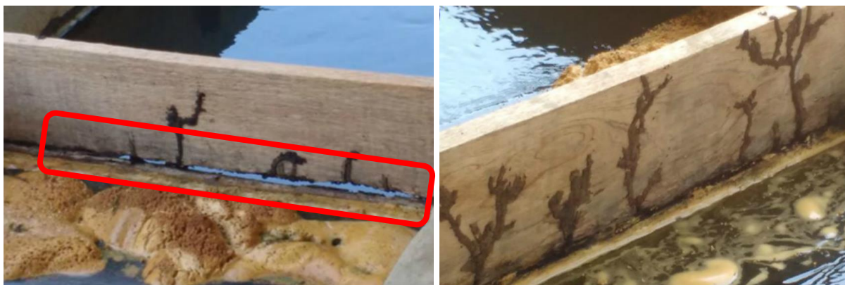
Figura 21 – Chicanas do floculador deterioradas
