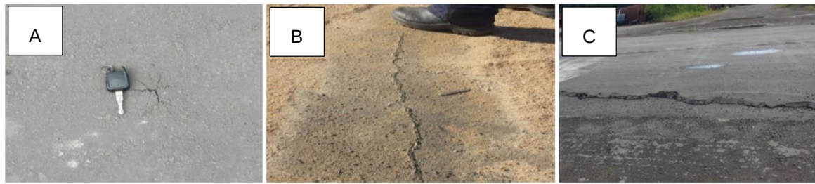
Figura 23 – Efeitos provocados pela expansão da escória em pavimentos asfálticos: (A) vulcãozinho; (B) fissura longitudinal; (C) quebra-molas.
