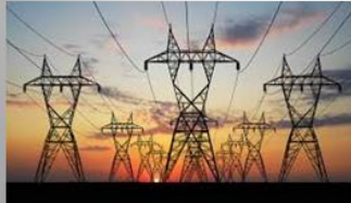
Figura 27. Linhas de Transmissão, disponível em : https://paralato.do.dia.com.br/na-eletricidade-tarifa-verde-e-energia-elétrica-permanece-muito-barrata-e-em-marcos
