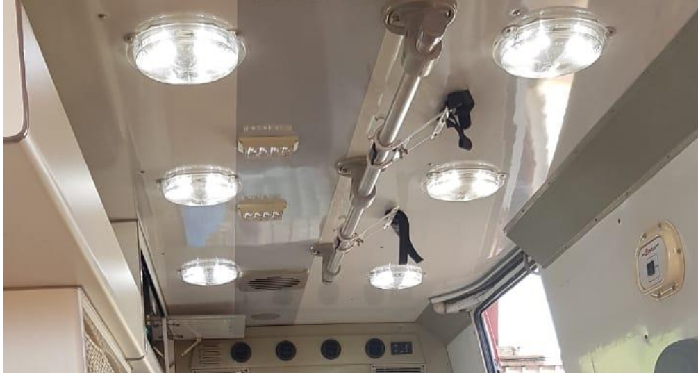
Figura 4. Iluminação artificial do ambiente de trabalho em duas linhas contínuas de luminárias.
