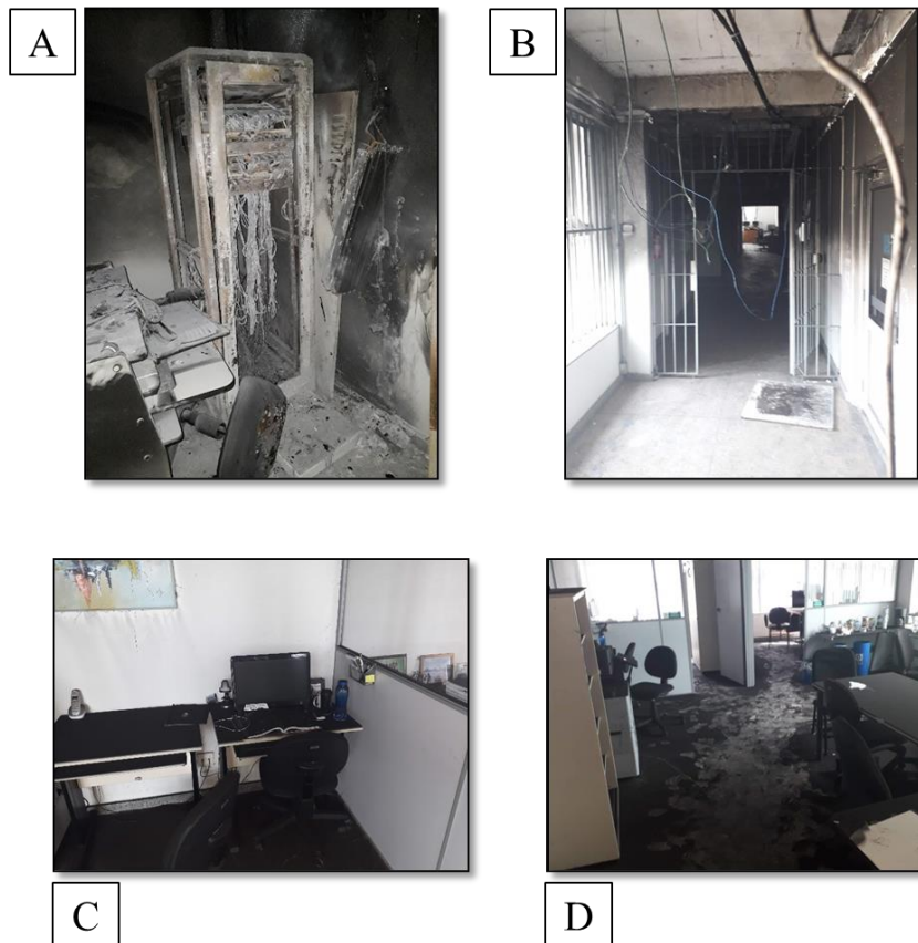
Figura 4. A, B, C e D – Imagens da destruição pós incêndio.
