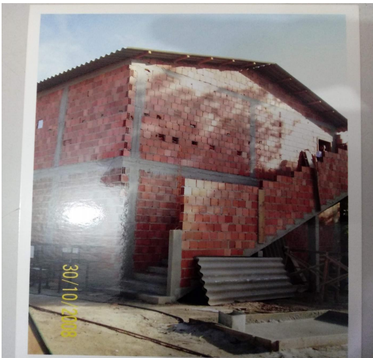
FIGURA 9 - FOTO DO LABORATÓRIO DE INFORMÁTICA DA EMEF CÓRREGO DO MILANEZ EM CONSTRUÇÃO.
