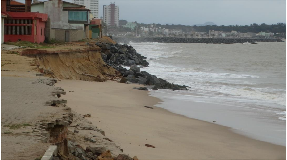
Figura 13 - Em destaque, processo erosivo que se instalou, e ao fundo é possível ver a atual esquema de proteção costeira, Marataízes – ES. Fonte: Prefeitura de Marataízes.
