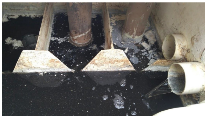
Figura 13 – Caixa de distribuição 02: Ponto de aferição da vazão do UASB.
