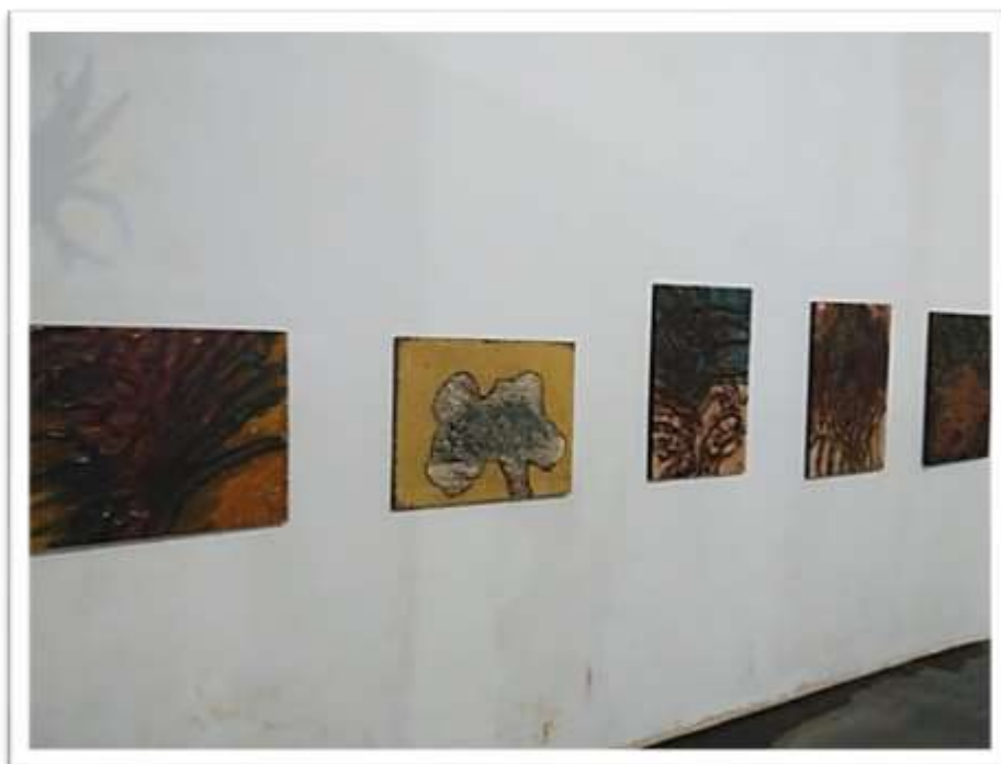
Figura 48 - Fotografias da área interna do pavilhão das sombras-recortadas, com o registro da presença de água no piso e umidade na base das paredes, Sítio Natura/BA, 2019. Fonte: Acervo pessoal.
