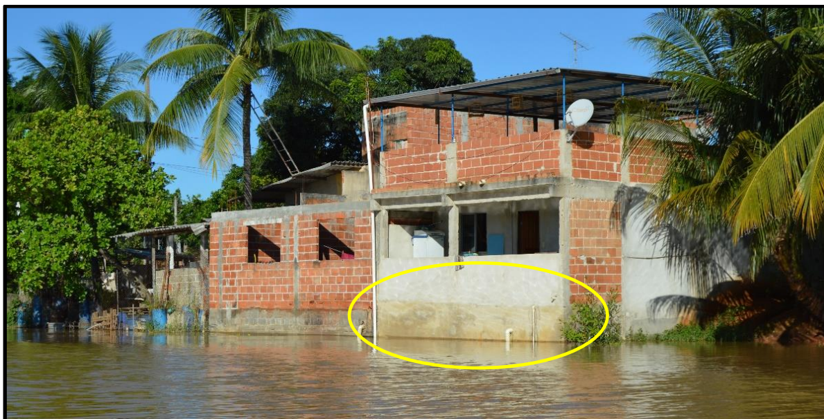
Figura 64 - Marca da água nos períodos de cheia do rio Piúma no ponto 3, 2017.
