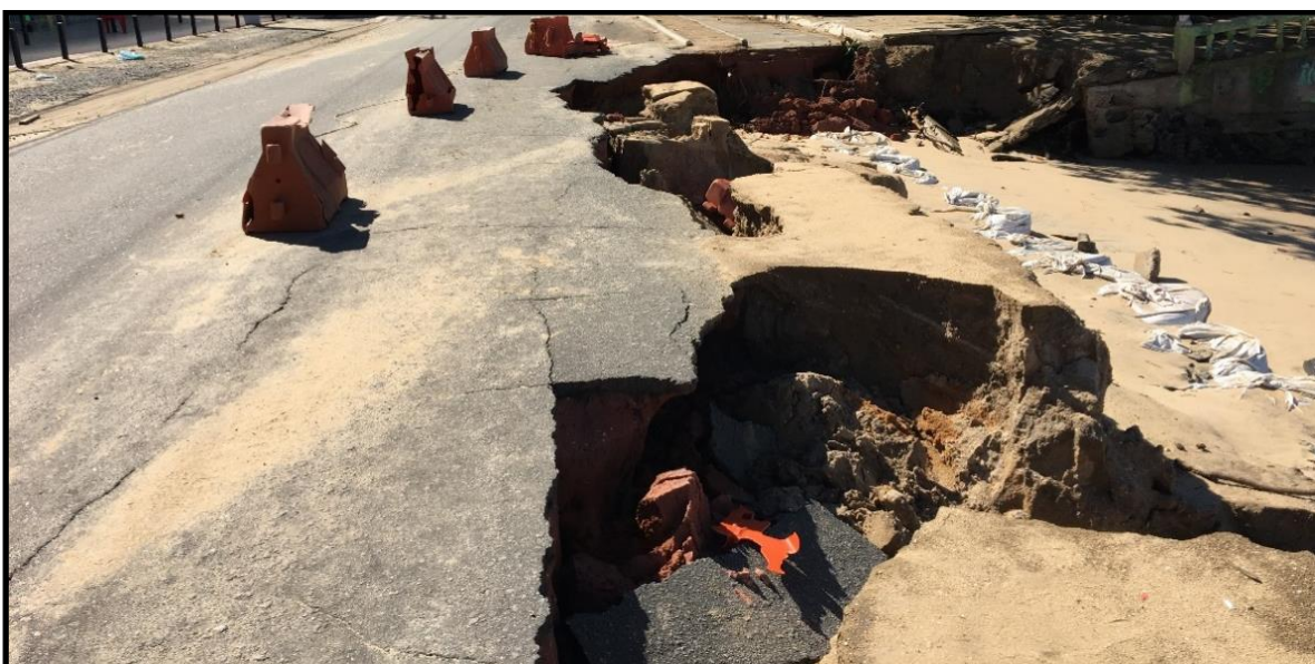
Figura 109 - Destruição da obra paliativa - Praia de Jardim Maily (b), 2019.
