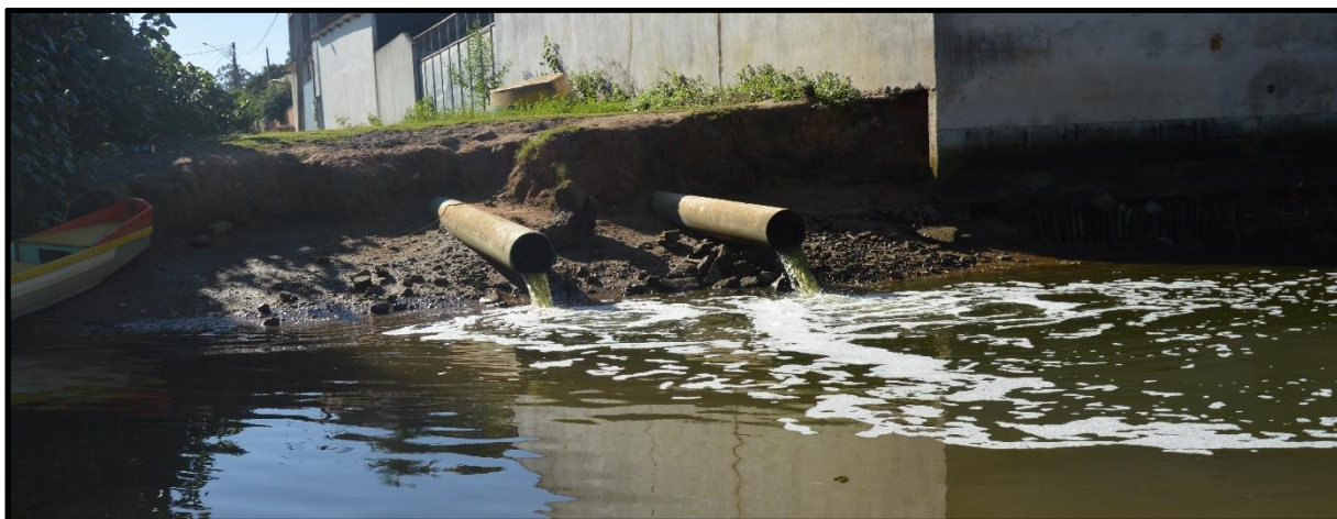
Figura 88 - Saída de efluentes após o tratamento na ETE Piúma, 2019.
