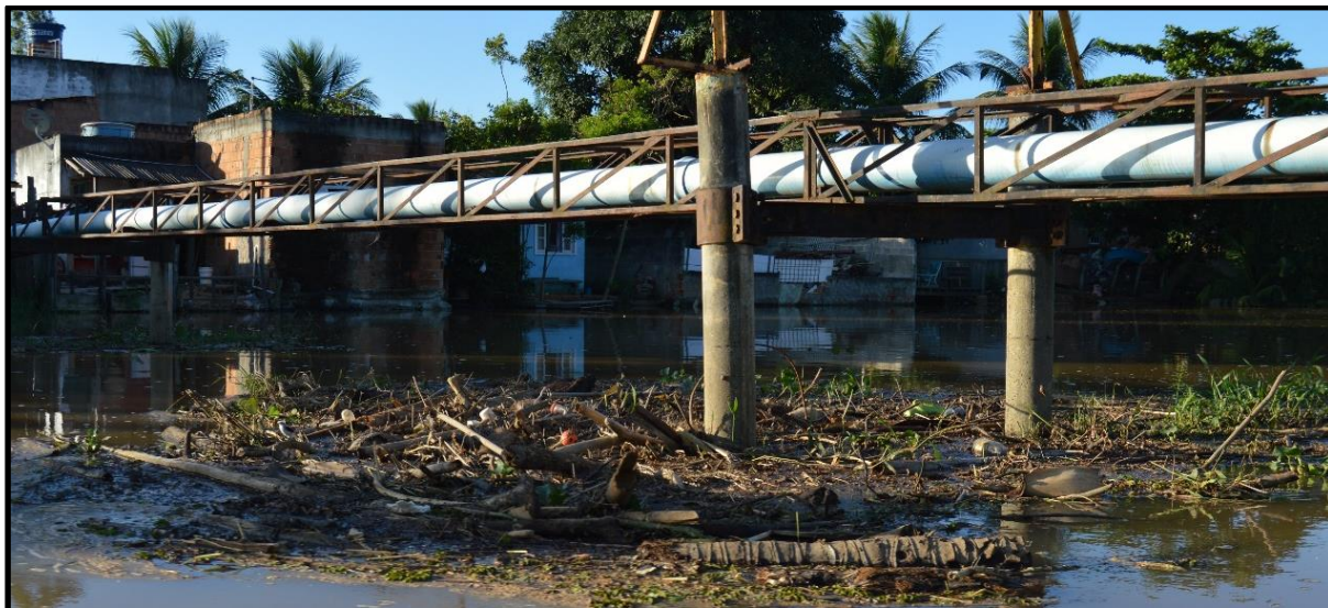
Figura 66 - Tubulação de esgoto suspensa, lixo e acúmulo de matéria orgânica, ponto 4, 2017.
