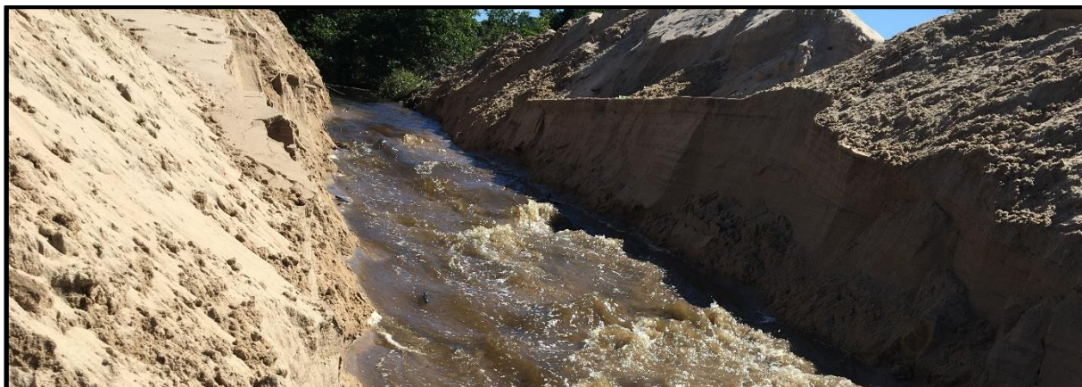
Figura 91 - Retirada do acúmulo de água pluvial e de esgoto doméstico na área dos fundos do IFES Campus – Piúma pela PMP (a), 2019.
