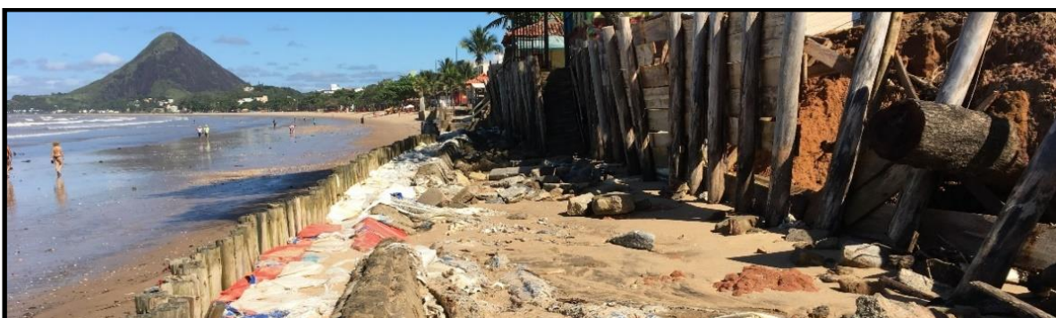
Figura 110 - Destruição da obra paliativa - Praia de Jardim Maily (c), 2019.
