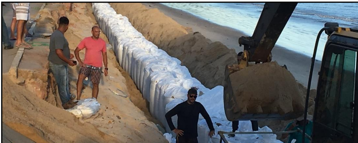
Figura 106 - Obra paliativa para contenção da erosão da orla - Praia de Jardim Maily (c), 2018.
