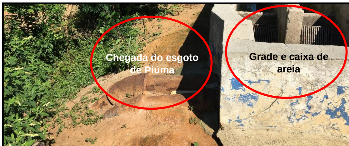
Figura 81 - Entrada de efluentes na lagoa anaeróbia, 2019.
