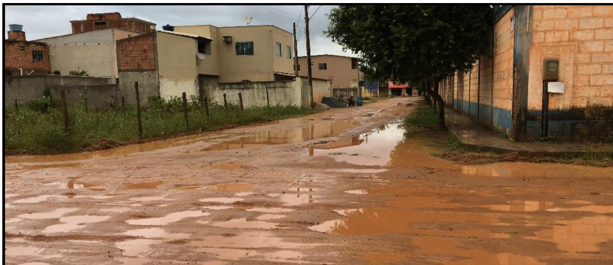
Figura 26 - Ausência de pavimentação nas ruas no bairro Piuminas, 2019.
