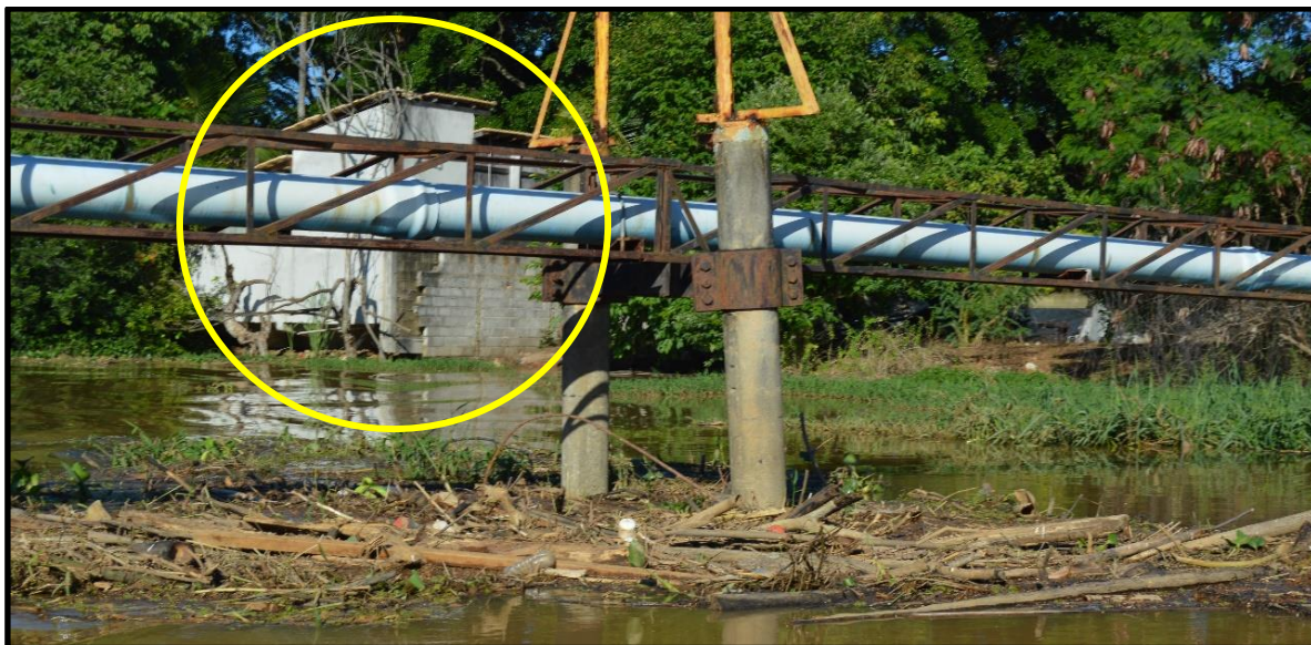
Figura 63 - Estação de captação de água da CESAN no rio Iconha, ponto 2, 2017.
