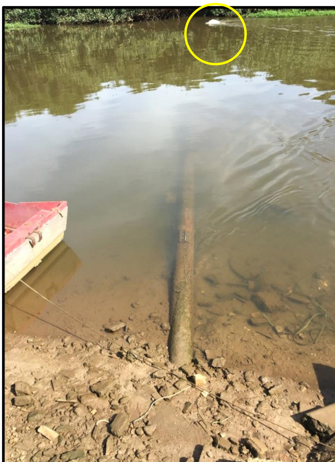
Figura 65 - Tubulação de esgoto submersa com vazamento entre os pontos 3 e 4.
