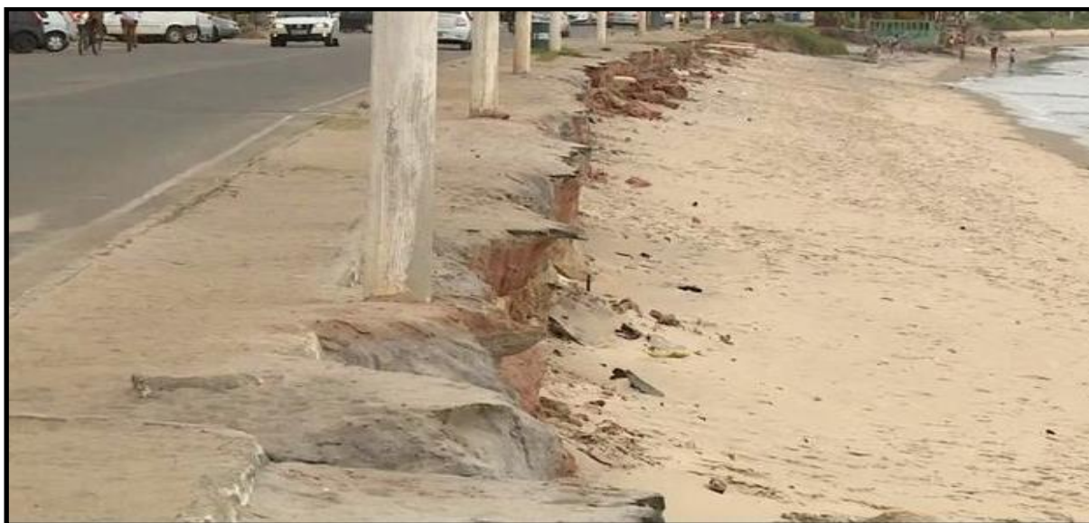
Figura 96 - Erosão na orla da praia de Jardim Maily, no ano de 2003.
