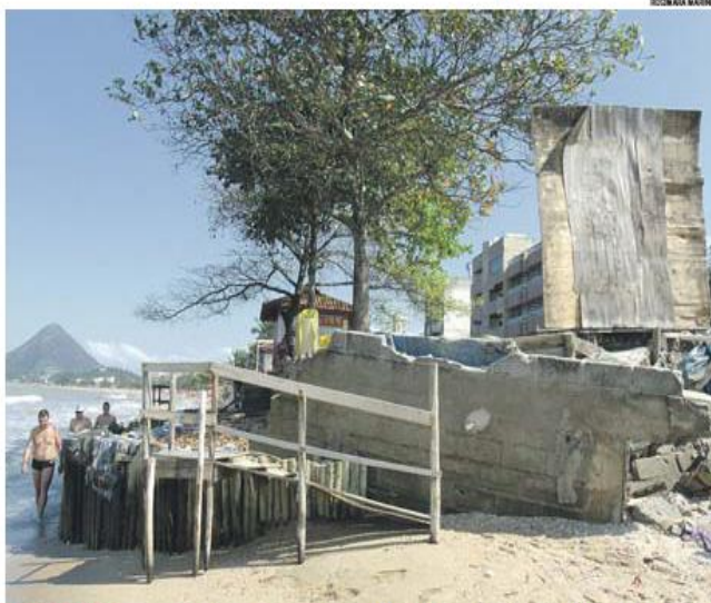
PRAIA DE PIÚMA sofre com erosão constante e buracos no calçadão. Moradores da região já fizeram um manifesto
