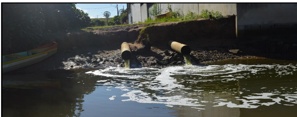
Figura 71 - Lançamento de efluentes da ETE no ponto 4, 2017.
