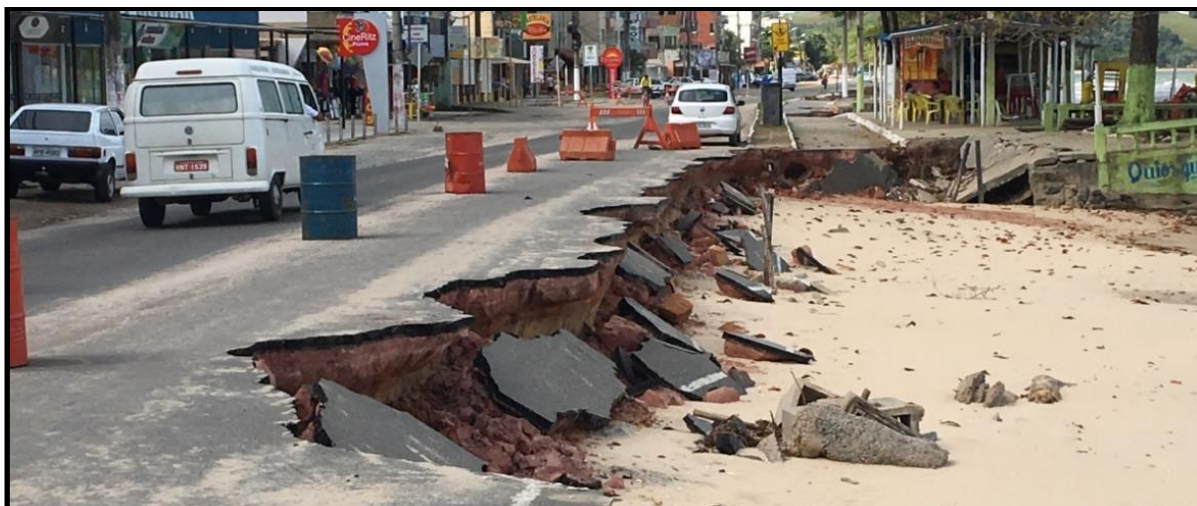
Figura 98 - Agravamento da erosão, sentido Itapemirim – Centro de Piúma, 2018.
