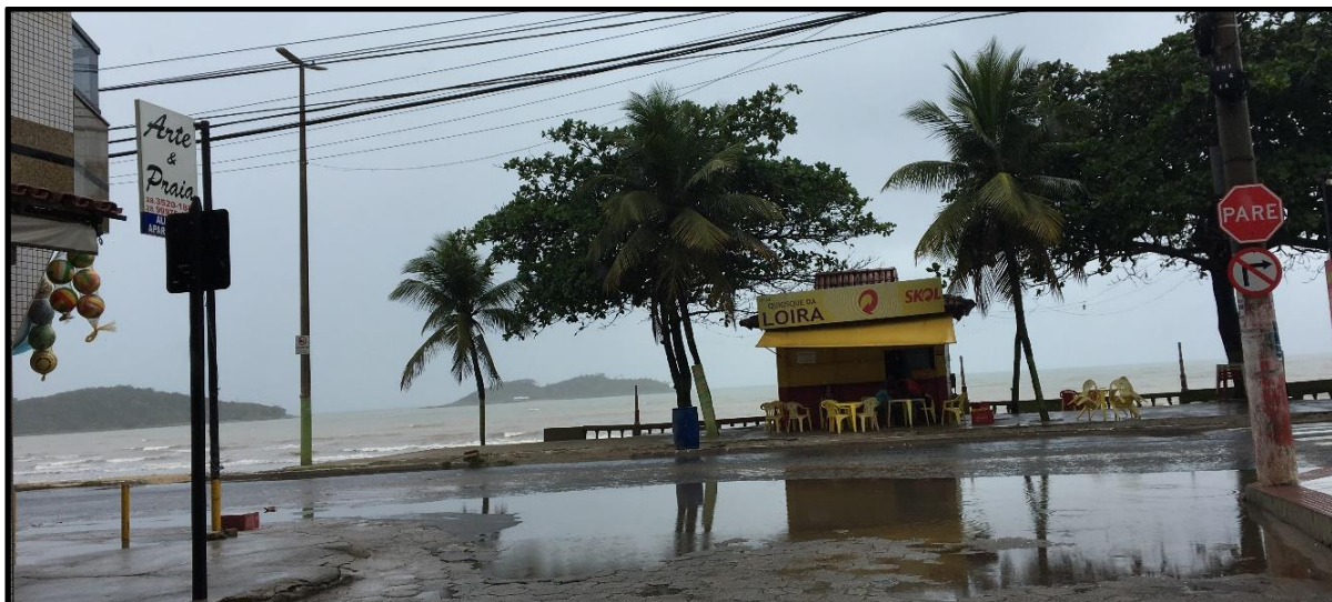
Figura 29 - Avenida Beira Mar - ausência de drenagem pluvial (a), 2019.
