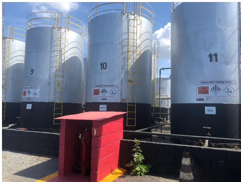
Figura 20 - Tanques de armazenamento de emulsões asfálticas na Disbral
