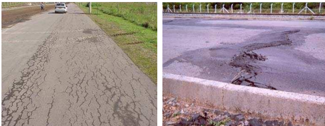
Figura 16 - Problemas em revestimentos devido à expansão da escória de aciaria
