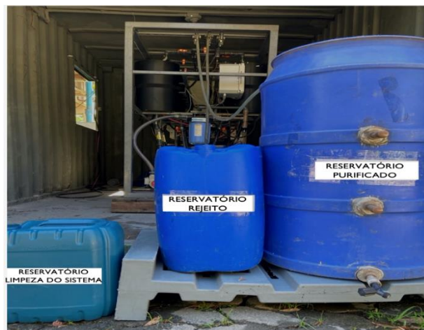
Figura 8 - Reservatórios correntes de saída do RDI
