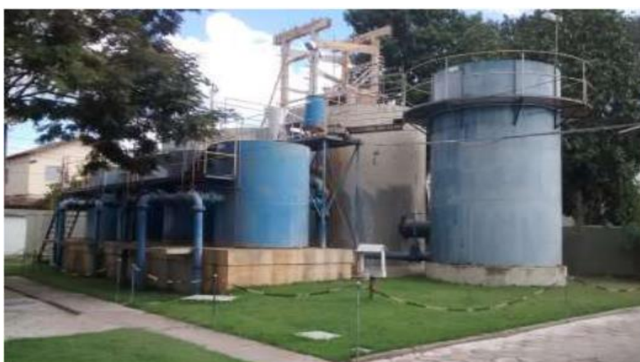
Figura 19- Registro das instalações de tratamento de água da Estação de Tratamento de água (ETA) Boa Esperança.
