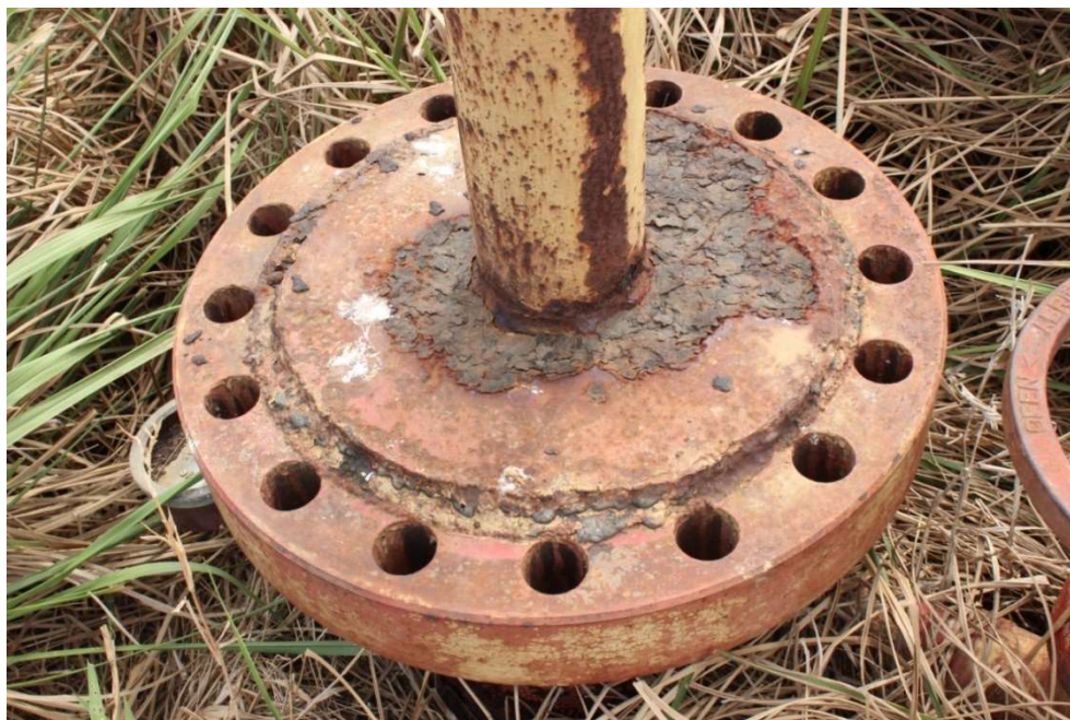
Figura 55: Estado de conservação da base do registro de vedação (enferrujada) do poço de petróleo e gás da Petrobrás em frente à Comunidade de Areal e Santa Maria
