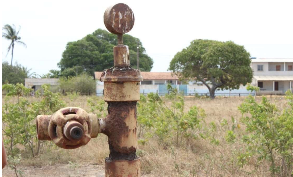
Figura 54: Registro de vedação de poço de petróleo e gás da Petrobrás, situado defronte à escola da comunidade Areal e Santa Maria, numa distância aproximada de 100 metros
