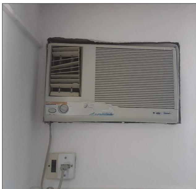
Figura 6 – Aparelho de ar condicionado do tipo janela instalado na SEAG
