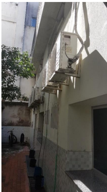
Figura 12 – Condensadores de ar condicionado instalados na lateral do prédio anexo da SEAG
