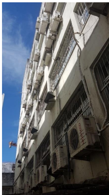
Figura 11 – Condensadores de ar condicionado instalados nos fundos do prédio principal da SEAG
