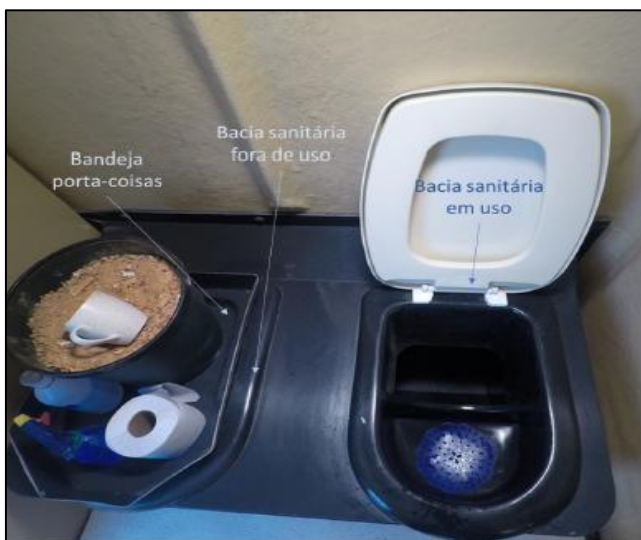
Figura 16: Vista das bacias sanitárias secas para coleta separada de fezes e de urina
