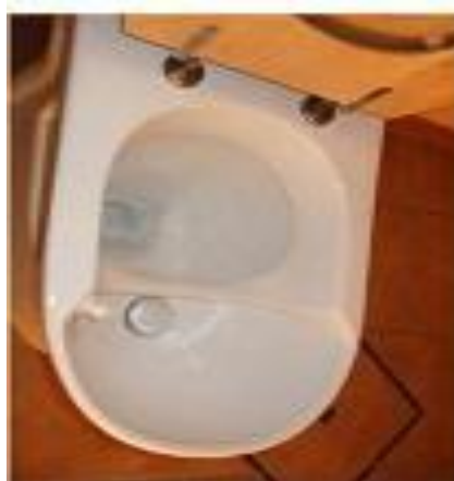
Figura 9: Vaso sanitário segregador a vácuo (1L/fezes, 0,5L/urina) - prédio GIZ, Eschborn, Alemanha. Fonte: Magri, 2013.
