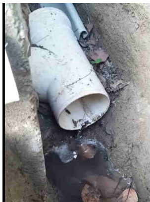
Escoamento no dreno de um dos módulos.
