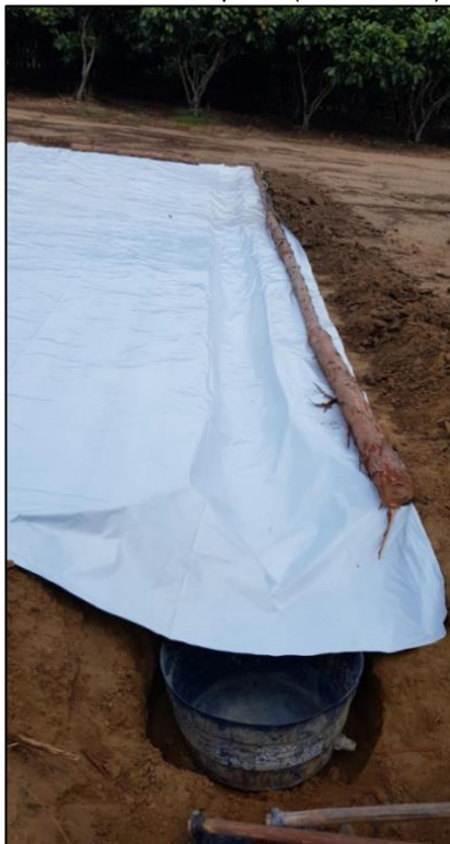
Figura 5: Calha para escoamento do líquido ("chorume") resultante do processo
