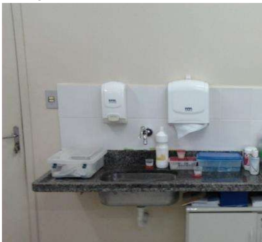
(a)- Pia com torneira acionamento manual- UBS Jardim Camburi
