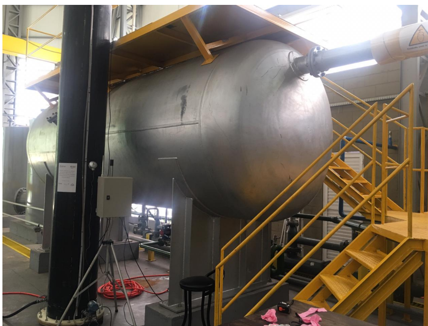
Figura 19. Imagem do vaso com escada para acesso a plataforma superior.
